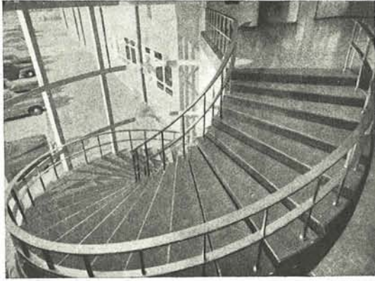
Fig. 10.—Las huellas de los escalones, de acero inoxidable y el pasamanos de bronce apoyado sobre barras verticales también de acero inoxidable, contribuyen a realizar el bello aspecto de esta audaz estructura.
