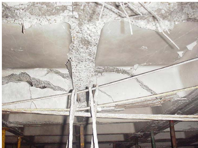
Figura 2. Daños por cortante en nervios de un forjado reticular (Aparcamiento Pza. Colón, Madrid, 2001).
