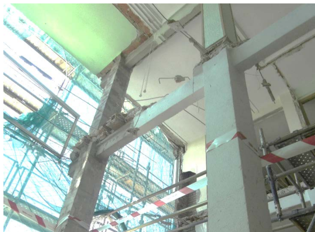
Figura 18. Fallos en forjados en un edificio tras una explosión de gas (Alcalá de Henares, Madrid, 2010).
