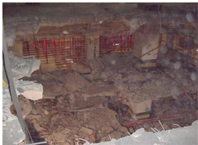
Figura 24. Fallo frágil del forjado en techo sobre el foco de la explosión (Centro Comercial en Zaragoza, 2002).
