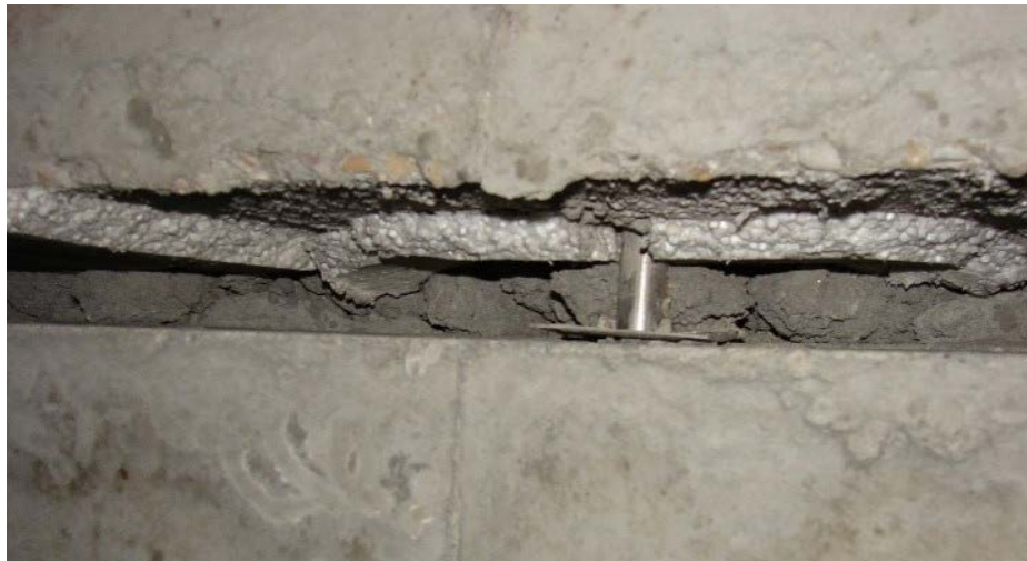
Figura 16. Abertura apreciable en una junta de forjado con pasadores tras los desplazamientos ocurridos como consecuencia de la explosión (Aparcamiento de Barajas, Madrid, 2006).
