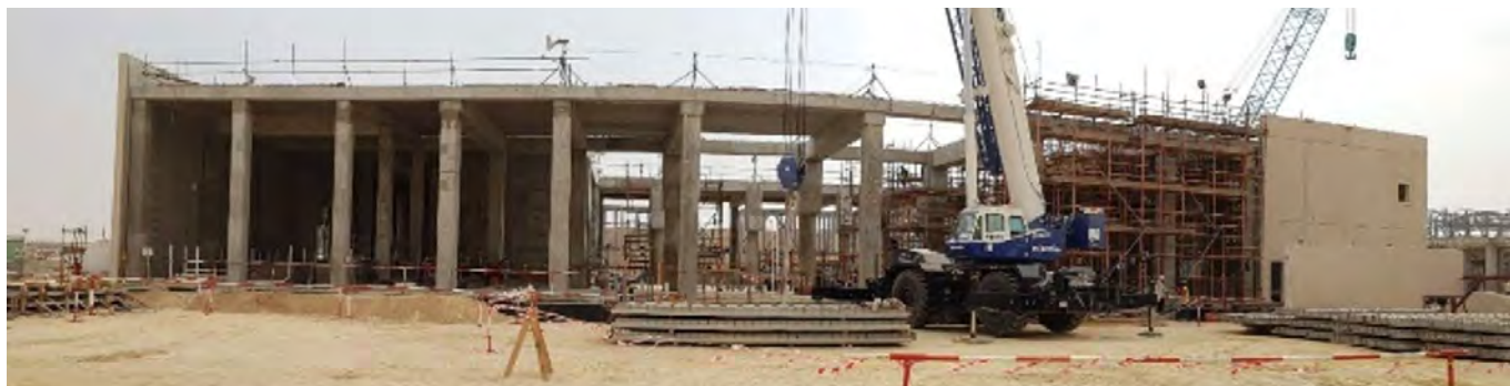
Figura 11. Edificio de control con solución híbrida.
