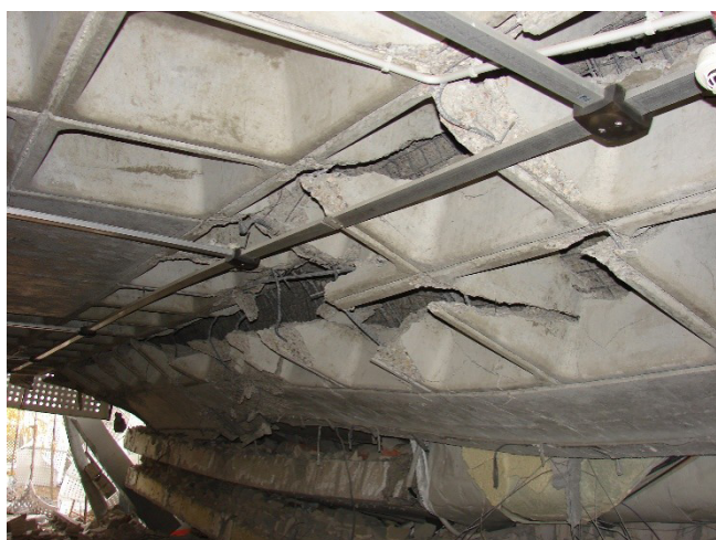
Figura 4. Rotura por cortante en una alineación de nervios de forjado a la salida del ábaco (Aparcamiento en Aeropuerto de Barajas, Madrid, 2006).
