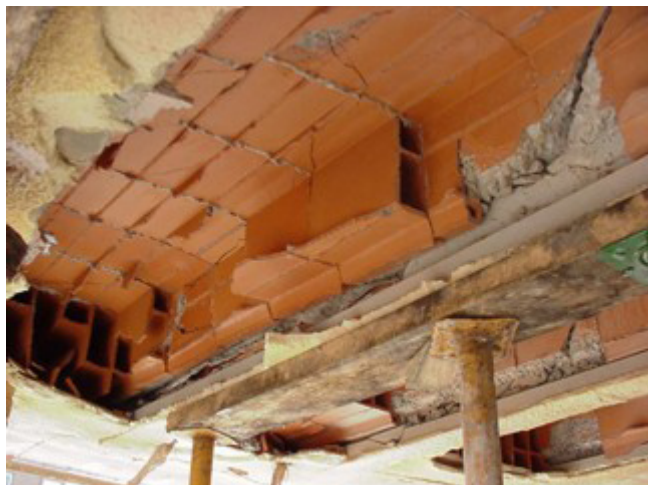
Figura 7. Fallo por rasante en un forjado unidireccional con vigueta semirresistente en "T" invertida (Edif. C/ Martín Gaité, Leganés, Madrid, 2004).
