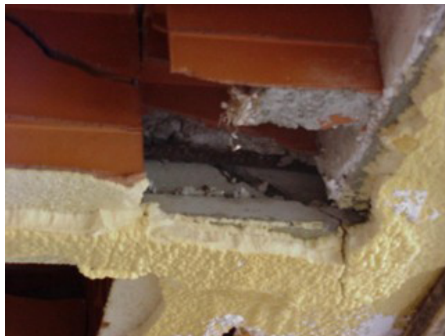
Figura 3. Rotura por cortante en un forjado unidireccional (Edif. C/ Martín Gaité, Leganés, Madrid, 2004).
