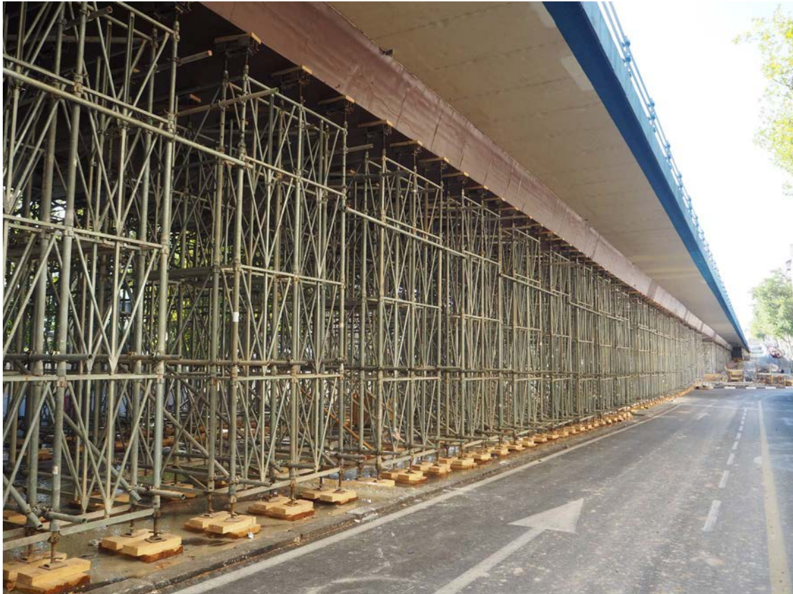
Figura 33. Cimbra cuajada instalada por ULMA. Vista desde pila P4 a estribo E2-1.
