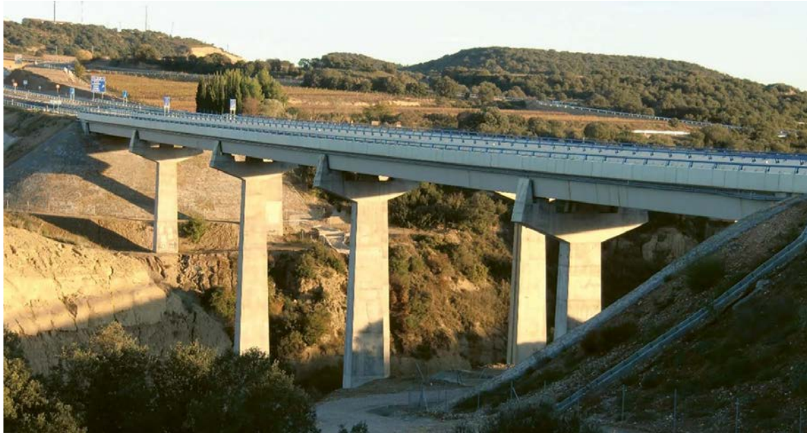
Figura 6. Imágenes de la duplicación del puente sobre el río Alcanadre (Huesca): vista inferior durante el montaje con lanzavigas, vista inferior y vista general acabado.
