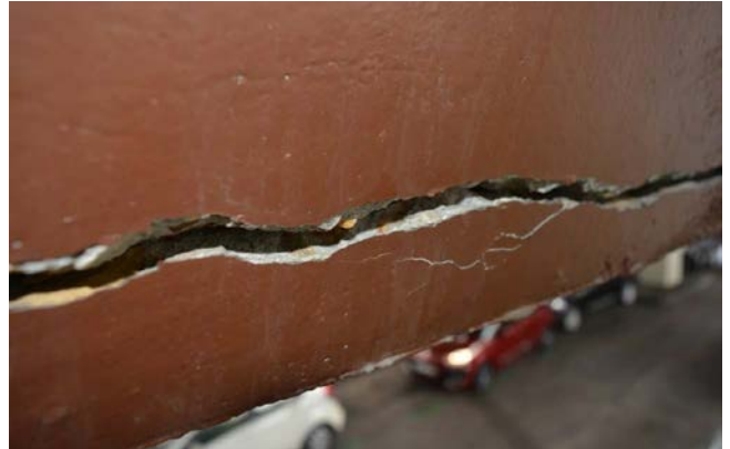
Figura 13. Grieta en vano 6 (suroeste de la estructura). Foto de los autores, 12 de febrero de 2020.
