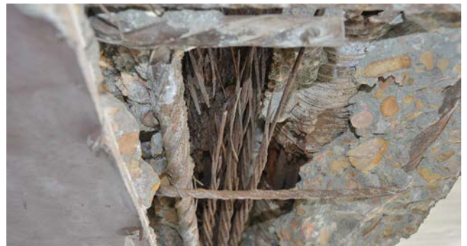
Figura 14. Tendón roto, sin lechada, detectado tras practicar una calicata en la zona de la figura 13 . Foto de los autores.
