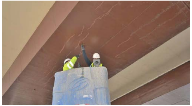
Figura 12. Fisuras longitudinales selladas en losa de fondo (foto de los autores, marzo de 2020).
