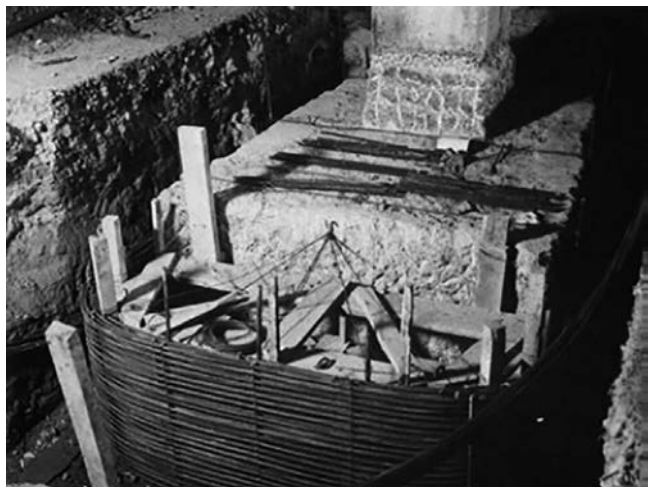
Figura 6. Bloques de anclaje en la Estación Marítima de Le Havre, solución de rehabilitación de Freyssinet (1934). (Reproducida de [7]).
