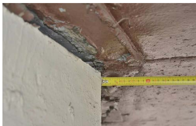
Figura 25. Corrimiento acumulado en la pila 9 (foto de los autores).
