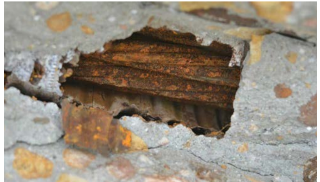
Figura 15. Tendón sin lechada en lado oeste del vano 6 (entre P-5 y P-6), en la calicata en la zona de la figura 13 . Foto de los autores, 12.02.2020.
