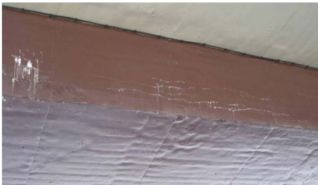
Figura 11. Fisuras longitudinales (foto del informe de inspección principal de INES Ingenieros Consultores, 2012, referido en [8] ).
