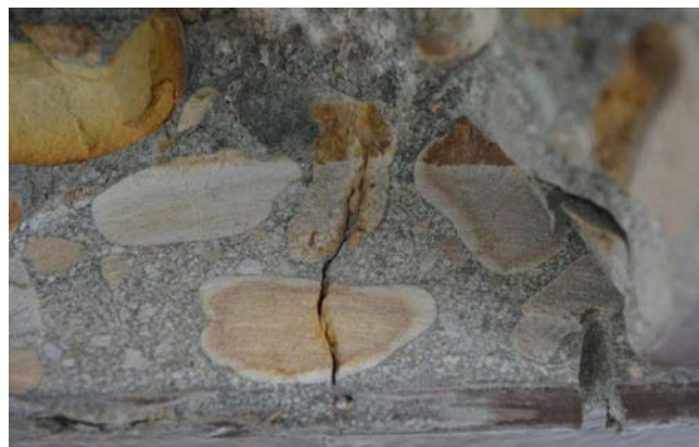
Figura 24. Áridos partidos y meteorizados en coincidencia con una fisura longitudinal (foto de los autores).
