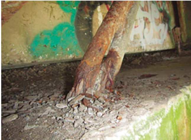
Figura 8. Estado barras antisísmicas.
