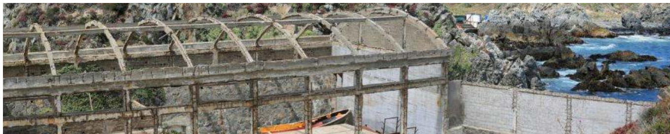
Figura 1: Corrosión severa en un edificio abandonado junto al mar (Ballenera de Quintay, Chile).
