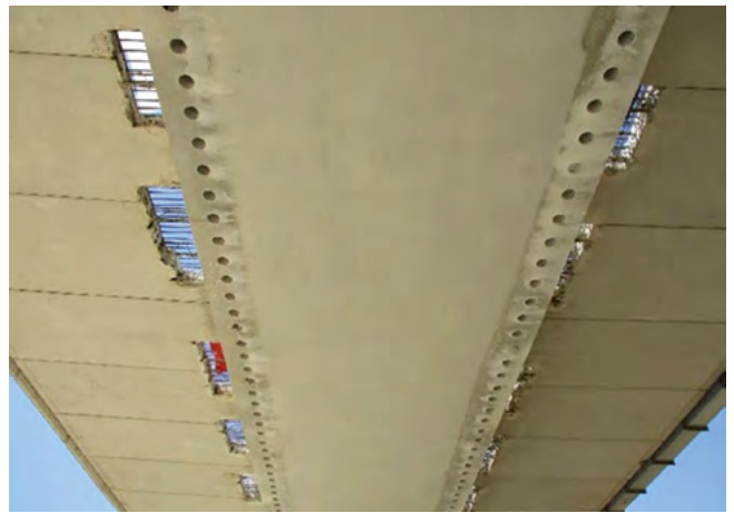
Figura 26. Vista inferior del tablero con las ventanas en el voladizo y los taladros en la losa inferior para alojar los pernos de conexión.
