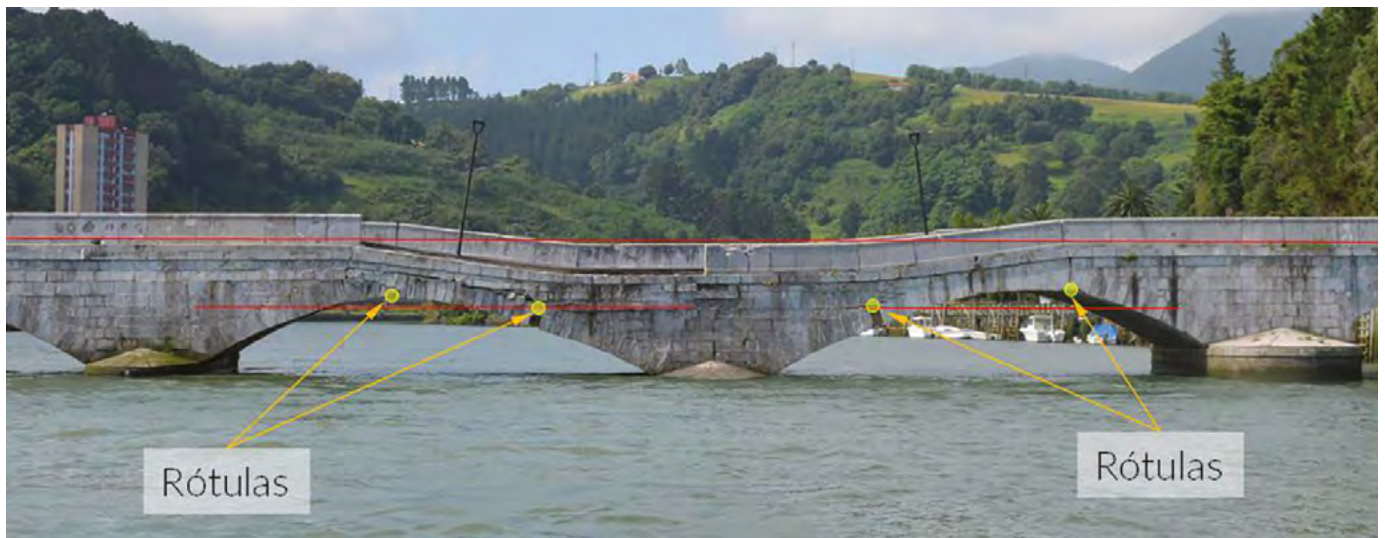
Figura 27. Puente de Deba tras el colapso parcial de la pila 2. Foto de los autores.
