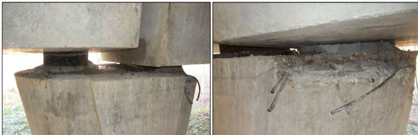
Figura 2. Izquierda: reptado y caída de un apoyo en el puente del ejemplo 1; derecha: rotura provocada en la coronación de la pila.
