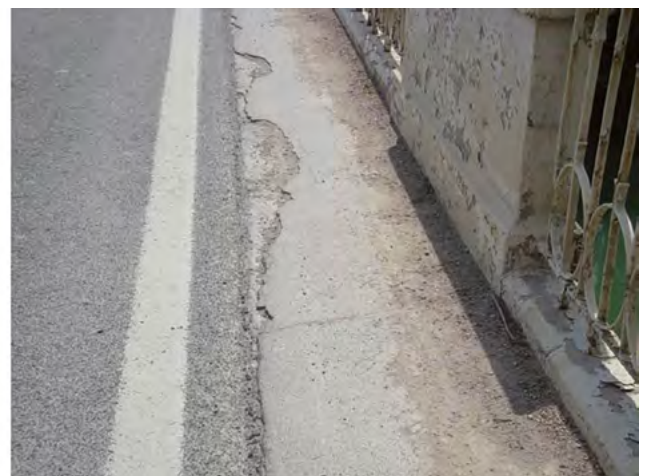
Figura 14. Sección transversal del puente de Liédena, antes de la reparación (figura de los autores), en la que se aprecia el espacio de hecho habilitado indebidamente para el cruce de vehículos.
