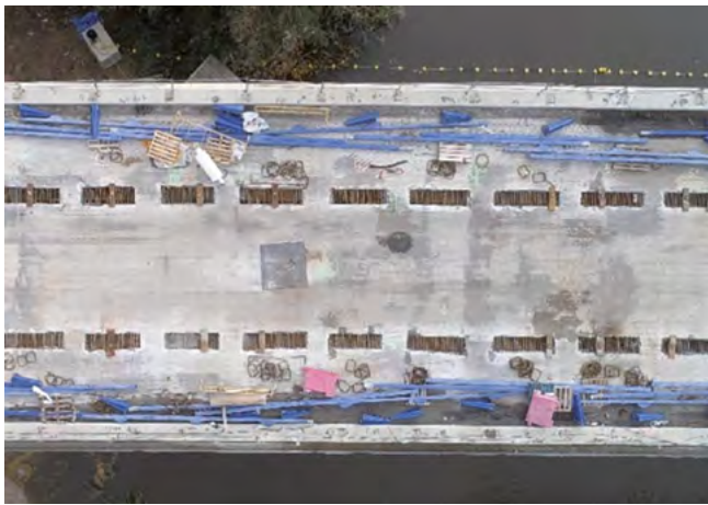
Figura 25. Vista en planta de la estructura con las ventanas ejecutadas en los voladizos para alojar los pernos conectadores de la platabanda superior.
