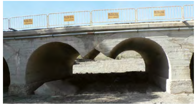
Figura 8. Puente en Puerto Lumbreras, 1 de octubre de 2012. Foto de los autores. A la izquierda se observa la pila socavada y volcada, con los arranques de las dos bóvedas acodalados precariamente entre sí.
