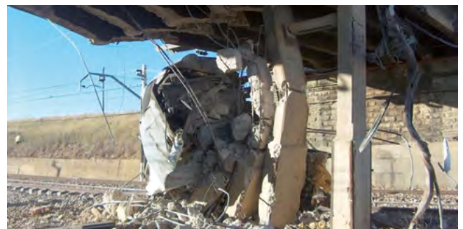
Figura 4. Impacto de un convoy ferroviario contra la pila de un puente en Villada, Palencia. 21 de agosto de 2006. Foto cortesía de ADIF.
