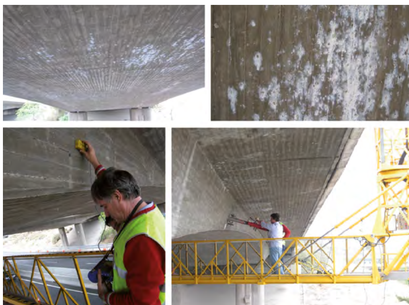
Figura 19. Estudio de un puente de hormigón postesado afectado por un ataque árido-álcali (2009).
