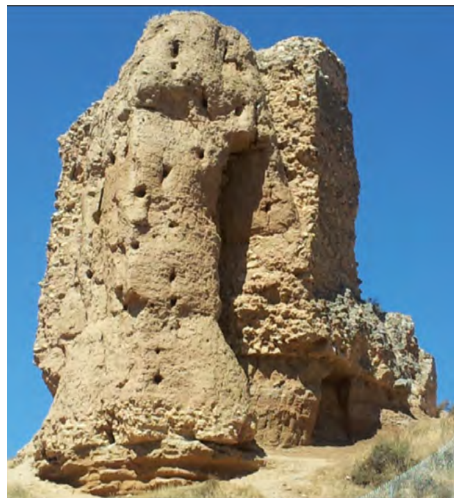
Figura 12. Estado de la torre en el año 2014.
