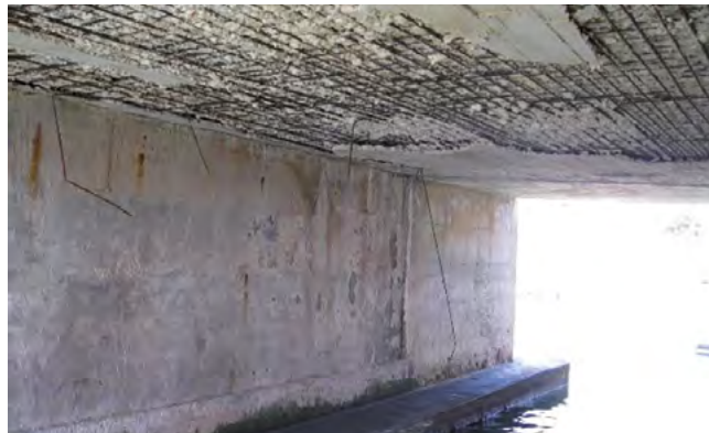
Figura 2. Deterioro avanzado de la losa del tablero de un puente. Fuente: GEOCISA, 2010.
