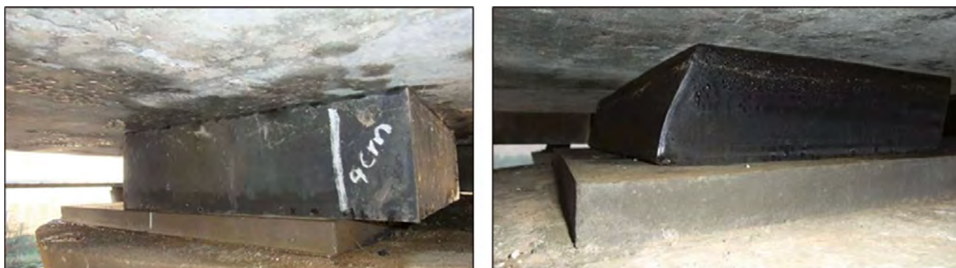
Figura 3. Izquierda: aparente reptado lateral de un apoyo en el puente del ejemplo 1; derecha: deformación en sentido longitudinal de un apoyo en el puente del ejemplo 1.
