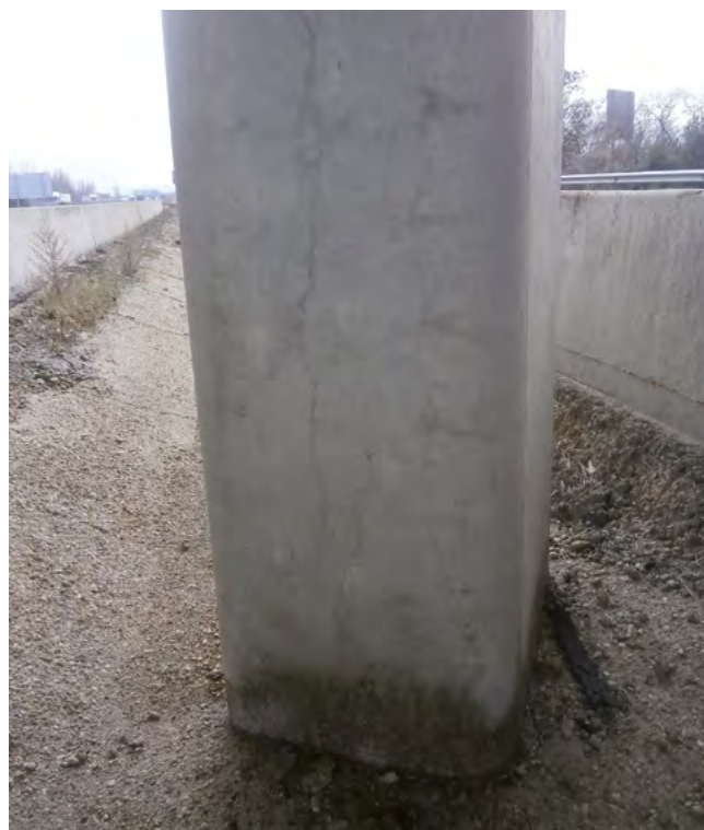
Figura 7. Fisuración vertical en una pila.
