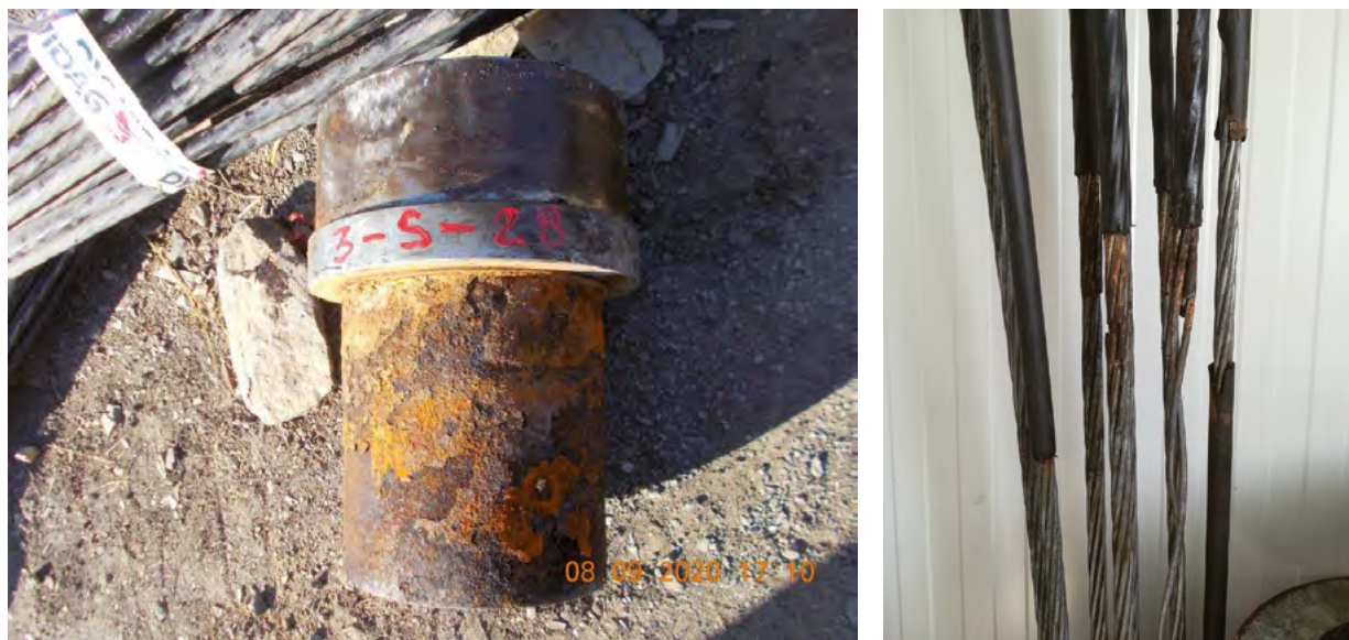
Figura 10. Elementos de anclaje del puente original (izquierda). Estado de los cables de tirantes (derecha).
