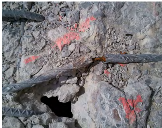
Figura 22. Armaduras corroídas en la interfaz hormigón prefabricado – hormigón in situ . Fotos cortesía de AUDENASA, concesionario que puede ponerse como modelo de actuación en la gestión del mantenimiento ordinario y especializado.
