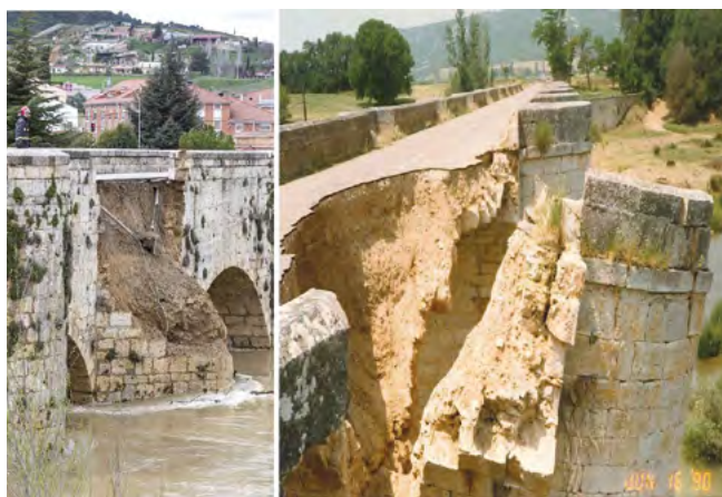
Figura 29. Ejemplos de rotura de tímpanos de puentes de piedra (a la izquierda, foto de prensa; a la derecha, cortesía de RODIO).
