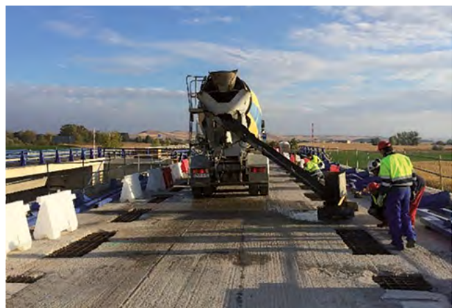
Figura 30. Hormigonado de las ventanas ejecutadas en los voladizos para alojar la conexión superior.
