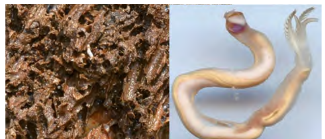
Figura 28. Aspecto del Teredo Navalis o broma y de sus efectos en la madera de los pilotes del puente de Deba (foto de los autores).
