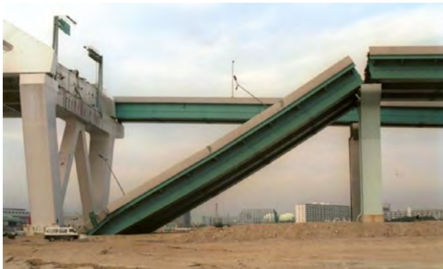
Figura 1. Colapso parcial del puente Nishihomiya, debido a la licuefacción del suelo durante el sismo de Kobe, 1995. Fuente: Wikipedia.
