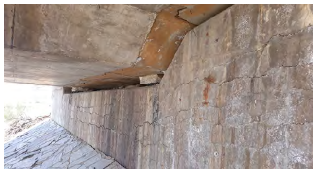
Figura 6. Fisuración horizontal en estribo.
