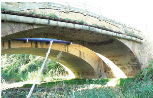
Figura 30. Ejemplo de colapso de parcial de puente de fábrica con bóveda rebajada de ladrillo. Puente de Ejea de los Caballeros. Foto de los autores.
