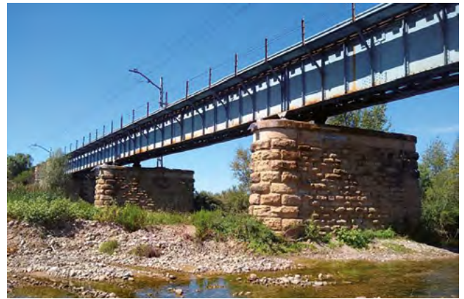
Figura 7. Vista general de equipos instalados en pilas del tramo metálico sobre el río Leza PK 065/097 línea Castejón-Bilbao. (Fuente: Tecsca-UPV).
