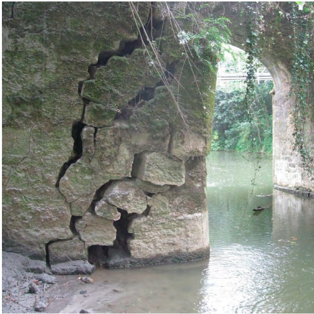
Figura 4. Detalle de grieta en estribo derecho.
