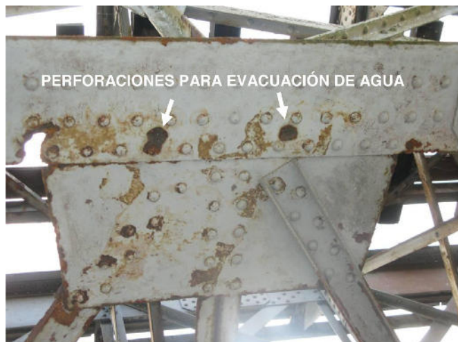
Figura 9. Hendiduras por corrosión en un patín inferior.
