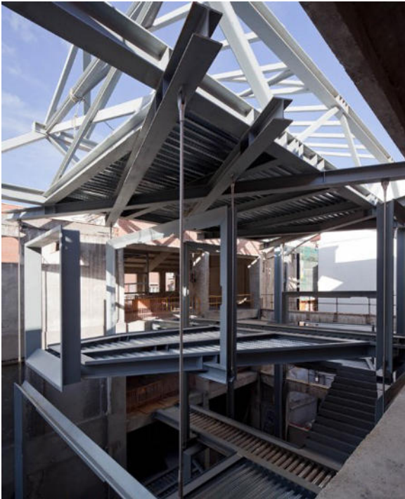
Figura 19. Vista general de la estructura metálica del núcleo de comunicación durante el proceso constructivo.
