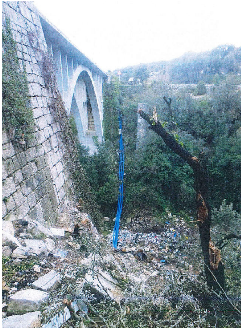
Figura 11. Colapso total de un pretil metálico dispuesto en la rehabilitación de un puente.
