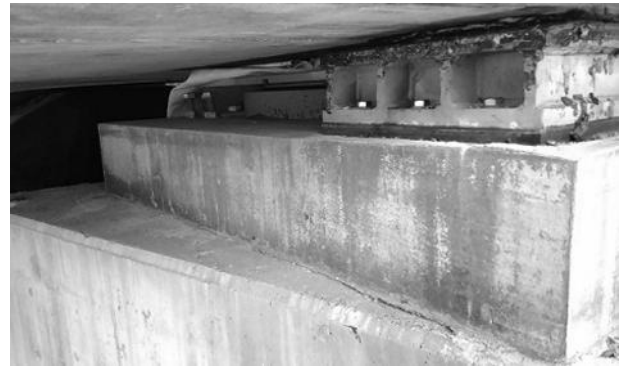
Figura 5. Detalle de chapas bajo apoyo temporal.
