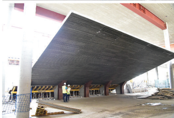
Figura 15. Graderío del salón de actos y cubierta sobre vigas mixtas. Vistas frontal y posterior.
