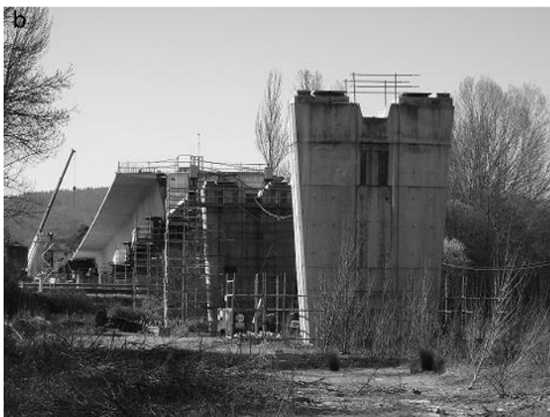
Figura 4. Vista lateral de estructura terminada (arriba) y vista durante la fase de empuje (abajo).
