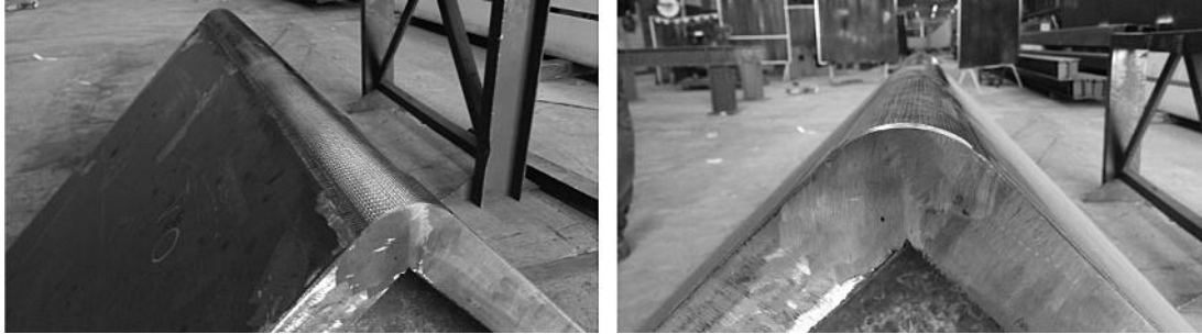
Figuras 33 y 34. Ensayo de soldadura y mecanizado posterior de la unión en arista del mástil.
