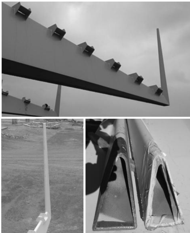
Figuras 37-39. Vistas de una costilla con montante vertical y detalle de chapa plegada.
