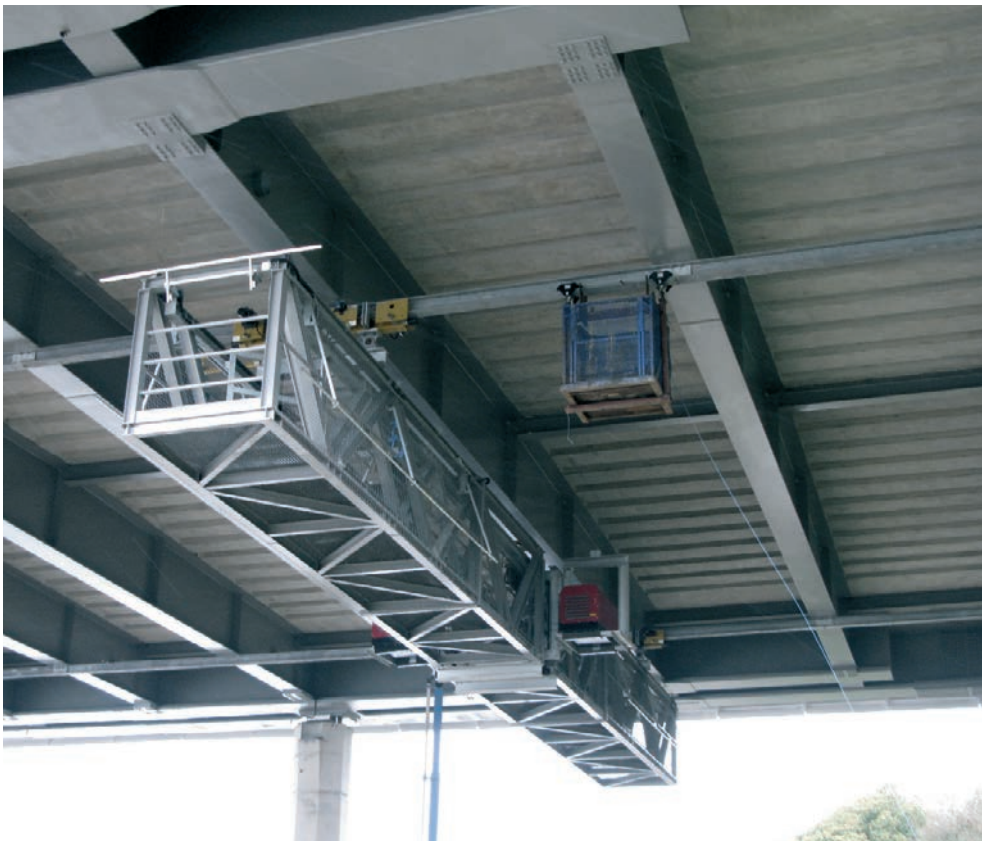
Figura 35. Carro de mantenimiento Figure 35. Maintenance gantry
