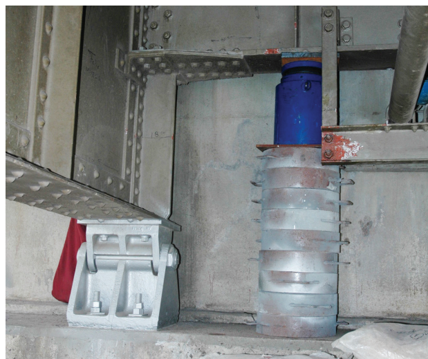
Figura 22. Levantamiento para reparación de apoyo en estribo Figure 22. Lift to repair bearing in abutment
