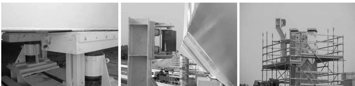
Figura 24. Detalles de apoyo en parque, guía lateral de estribos, y apoyo doble en fuste y guía lateral en pila
