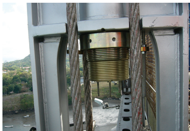
Figura 28. Nuevo anclaje inferior con cuñas Figure 28. New bottom unions equipped with wedges
