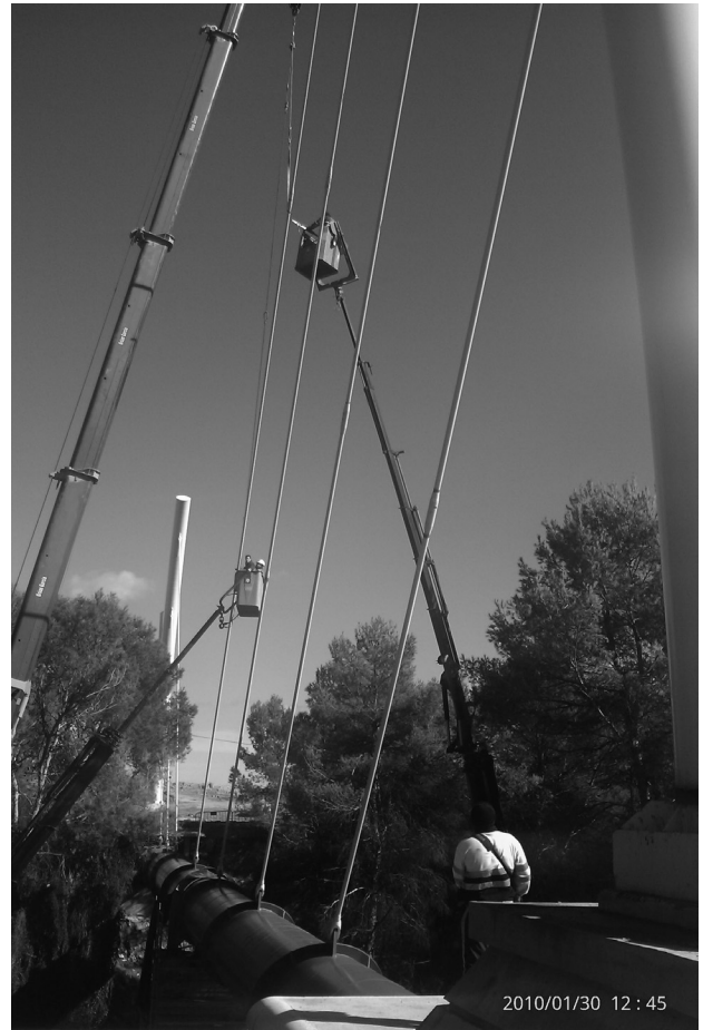
Figura 10. Roscado de las barras
