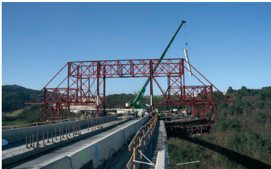
Figura 38. Carro n.º 3 y colocación de un nuevo jabalcón Figure 38. Movable scaffolding n. 3 assembling a steel strut
