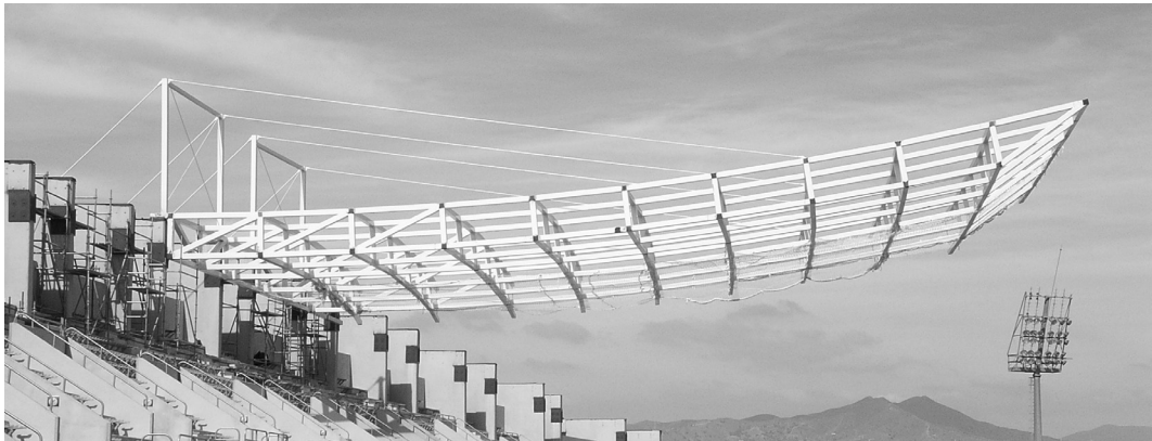
Figura 18. Cubierta durante su fase de trabajo en ménsula durante el montaje, mediante atirantamiento trasero
