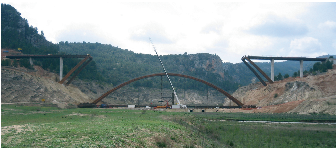
Figura 12. Montaje de la estructura metálica, con el bowstring y los voladizos laterales Figure 12. Steel structure assembly: bowstring and side cantilevers
