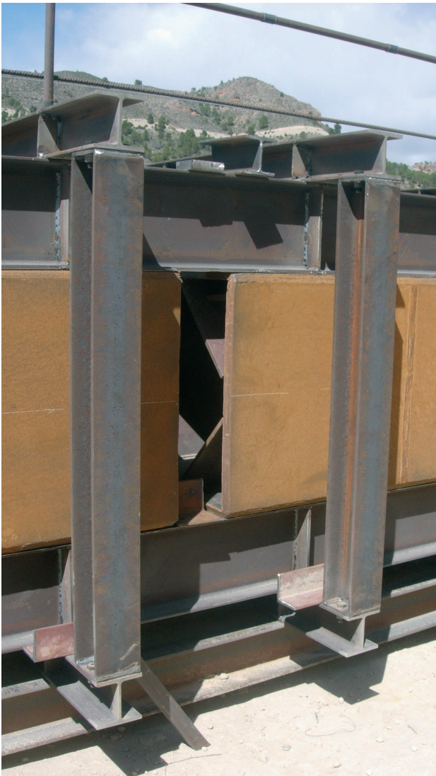
Figura 51. Apertura de riostra Figure 51. Gap in brace
