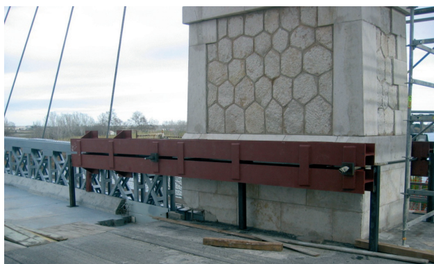
Figura 7. Sistema de bloqueo del tablero. Figure 7. Deck blocking system.
