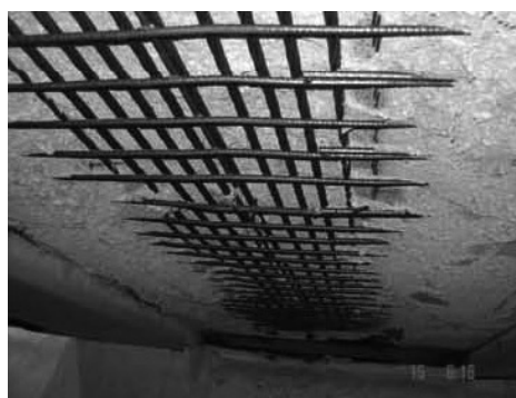
Figura 37. Spalling en la cara inferior.
