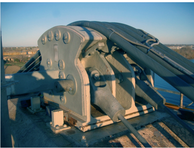
Figura 28. Una de las sillas rehabilitada, mostrando la cara de los terminales de cables de retenida.
