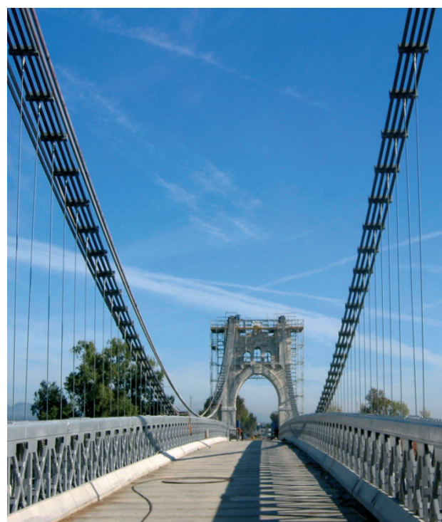
Figura 25. Cables nuevos finalizada la transferencia de carga. Figure 25. New cables after load transfer.
