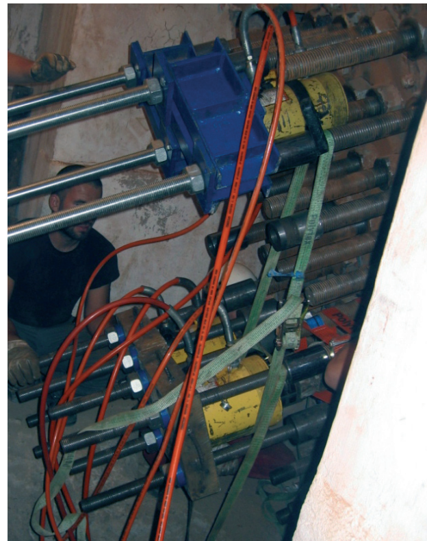
Figura 9. Tesado de cables desde las cámaras de anclaje. Figure 9. Tensioning cables from anchorage chambers.
