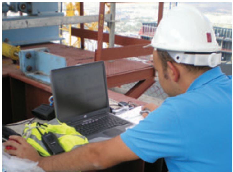
Figura 29. Control informatizado del sistema hidráulico Figure 29. IT monitoring of the hydraulic system.
