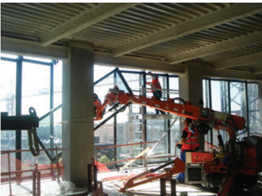
Figura 14. Montaje de los paneles de la fachada desde el interior del edificio. Figure 14. Assembly of the façade panels from the inside of the building.
