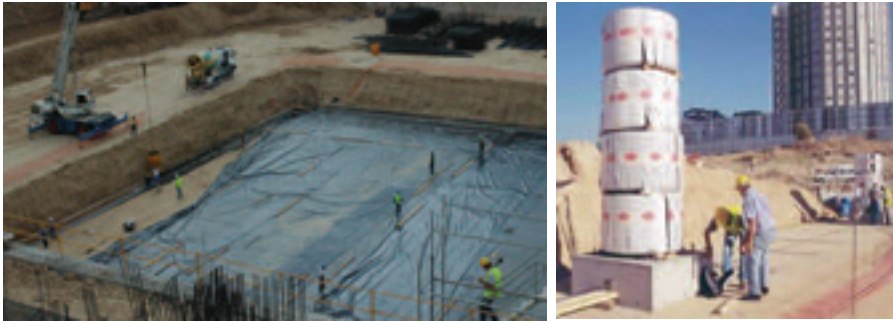
Figura 6. Dispositivos para reducir el rozamiento entre el terreno y la losa de cimentación: colocación de la doble lámina de polietileno (izqda.) y ensayo en verdadera magnitud de su eficacia (dcha.)
