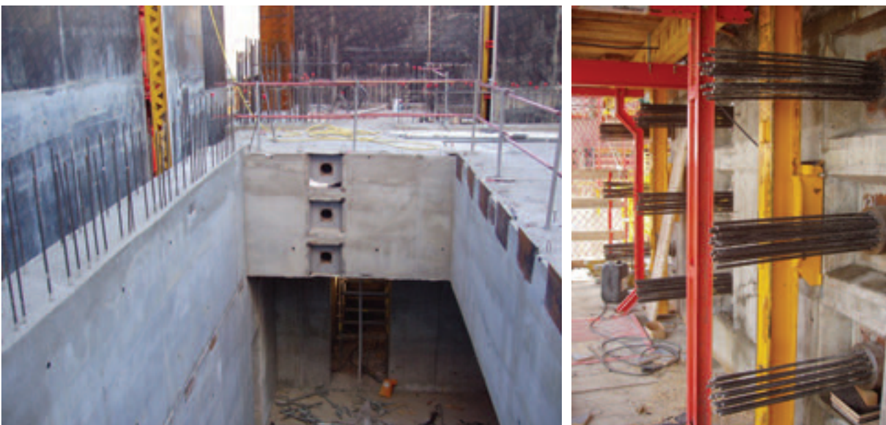
Figura 18. Losa desencofrada. Vista antes y después del tesado de cables. Figure 18. Stripped slab. View before and after cable tensioning.
