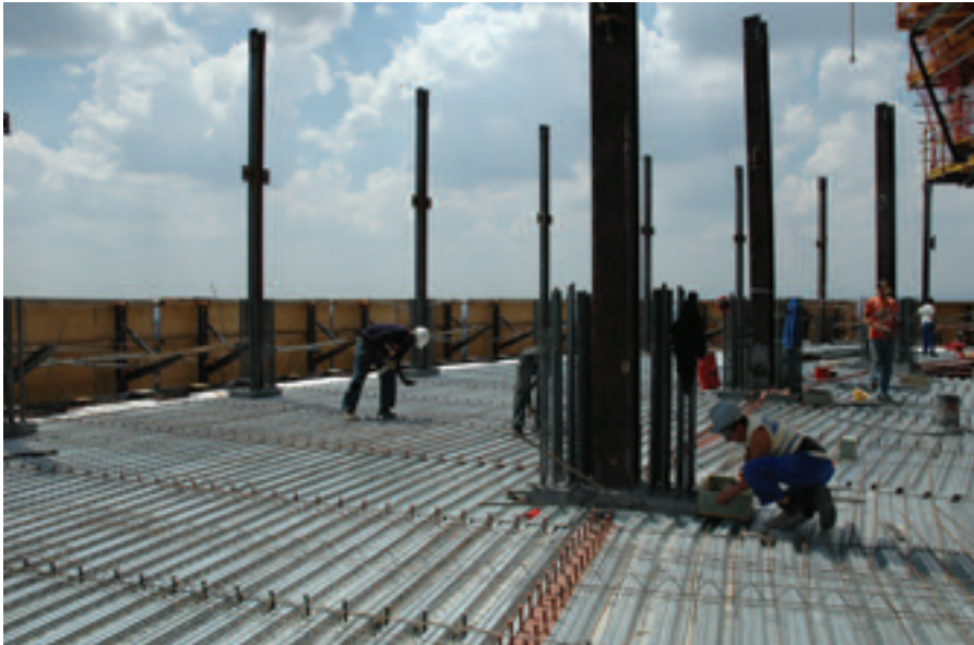
Figura 22. Montaje de la chapa plegada del forjado con el despiece adaptado a la geometría radial de la planta.
