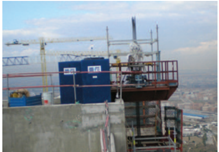
Figura 28. Plataforma de gatos en coronación de núcleo. Figure 28. Core crown platform for jacks.
