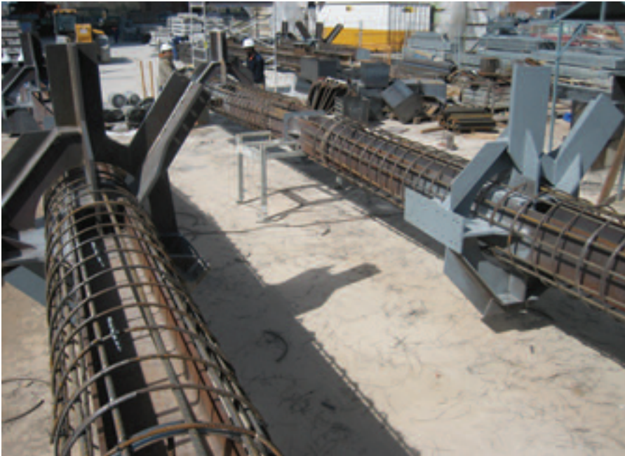
Figura 12. Pilares mixtos ferrallados en zona de acopio Figure 12. Composite columns wrapped in reinforcing steel.
