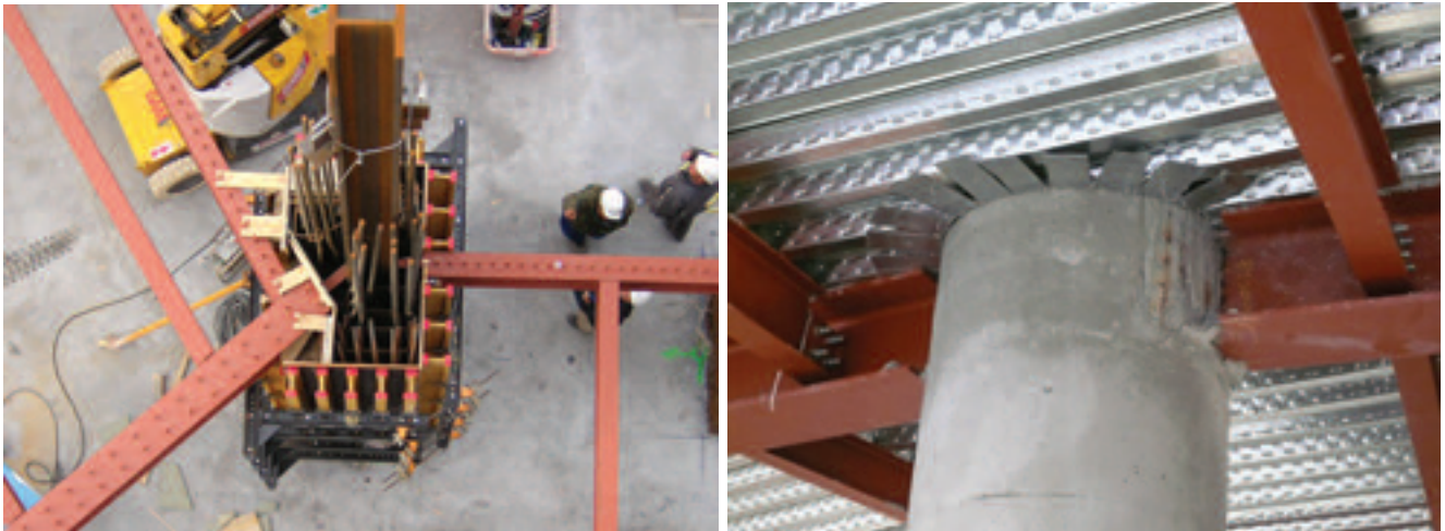
Figura 20. Preparación de las cabezas de encofrados para salvar las vigas. Figure 20. Preparation of the formwork caps to avoid the beams.
