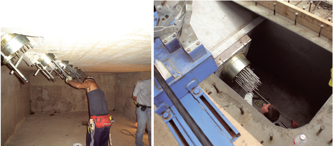
Figura 24. Anclajes fijos en macizo de retención y en tablero. Figure 24. Fixed anchorages at the retention block and at the deck.
