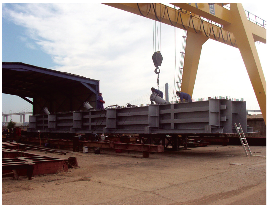
Figura 15. Módulo central del tablero por zona de anclajes de tirantes. Figure 15. Central unit of the deck in the stays anchorage area.
