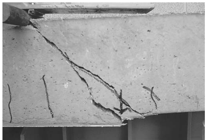
Foto 4. Rotura por cortante desde el extremo de la fibra. Rotura tipo 8.
