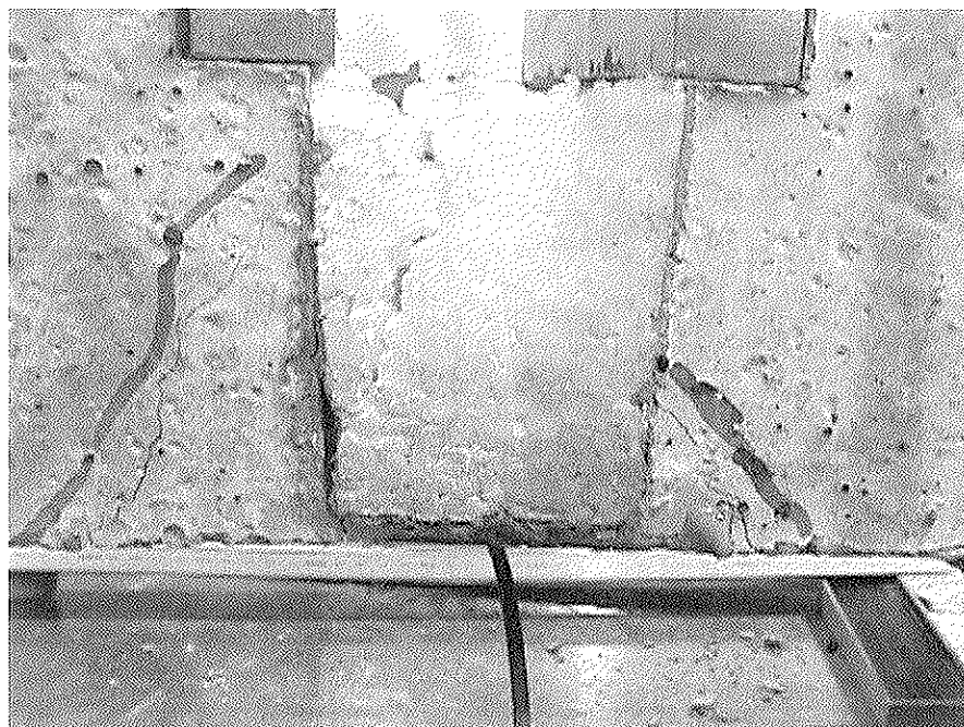
Figura 13. Detalle de la fisuración en la zona central.
