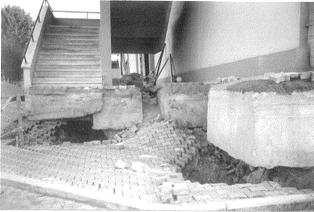
Foto 5. Cimentación del polideportivo elevada por subsidencia del suelo.
