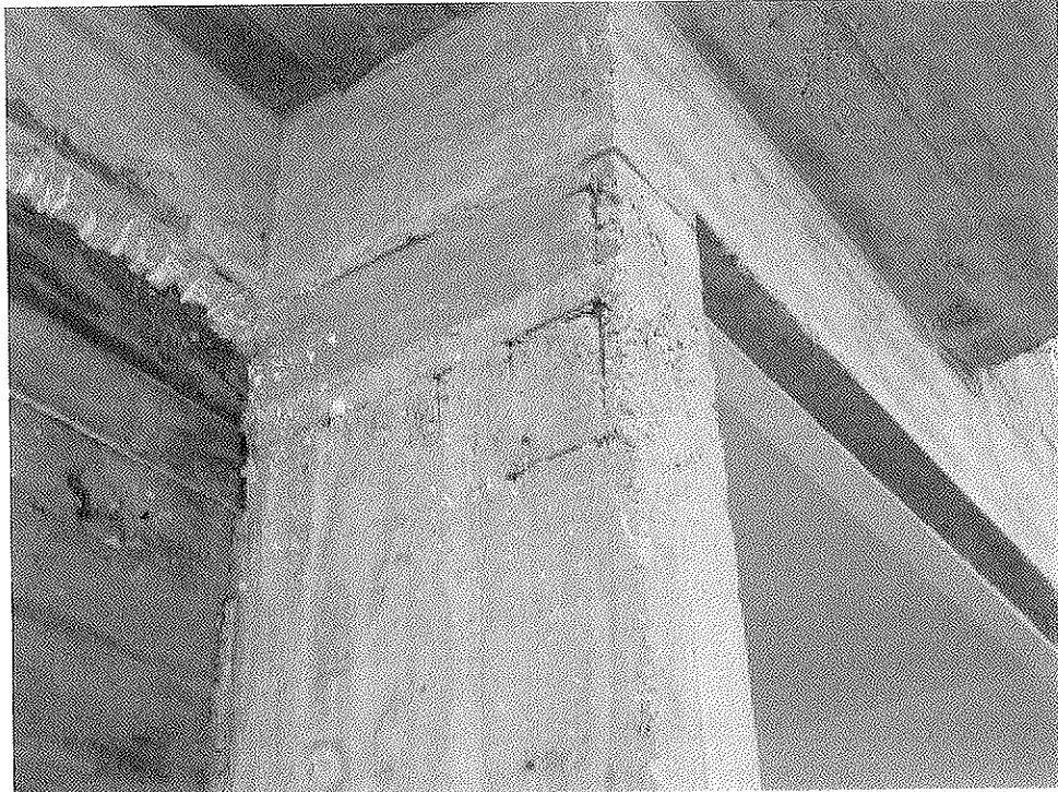
Foto 11. Estructura en construcción donde se detecta la falta de recubrimiento.
