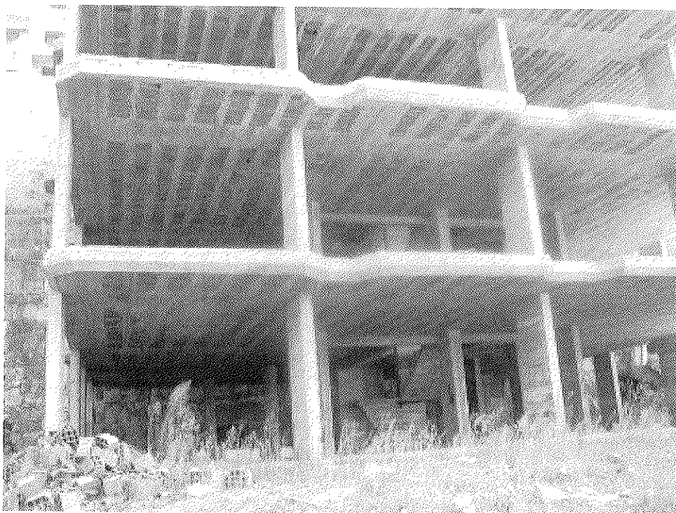
Foto 13. Elementos estructurales de dimensiones insuficientes.
