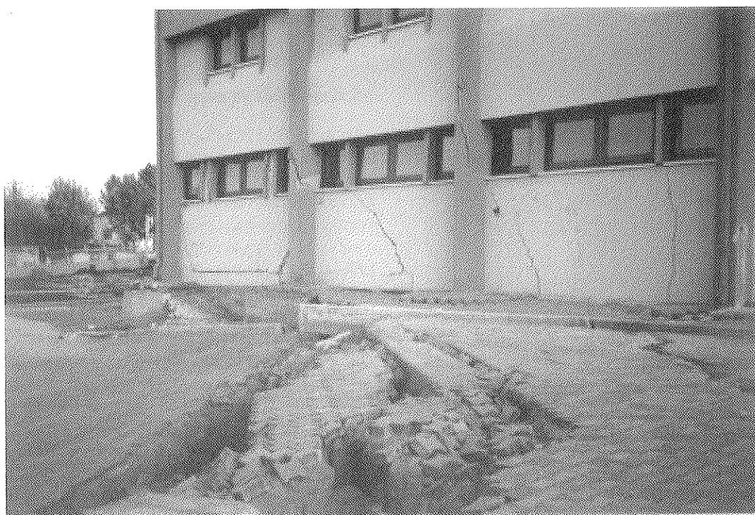
Foto 4. Polideportivo en Gölcük, atravesado por la traza de la falla.
