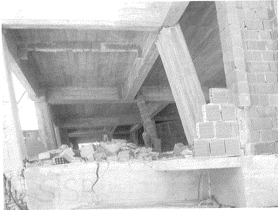
Foto 20. Edificio en construcción con rótulas plásticas y mecanismos de colapso.
