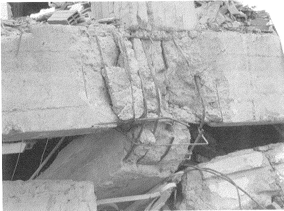
Foto 8. Nudo viga-pilar con acero liso insuficiente y de baja ductilidad.
