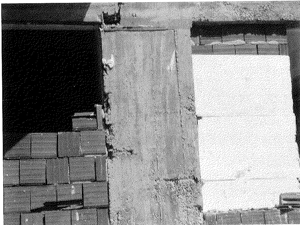
Foto 12. Estructura en construcción donde se aprecia la falta de vibrado del hormigón.
