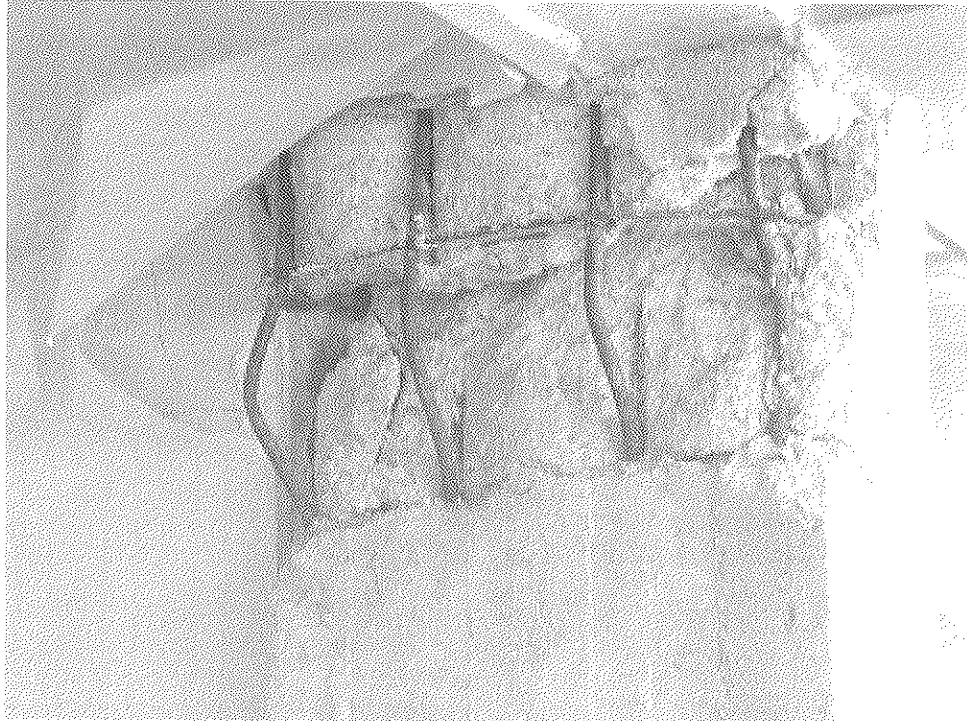
Foto 9. Pilar fallado con poco acero transversal y alta corrosión.
