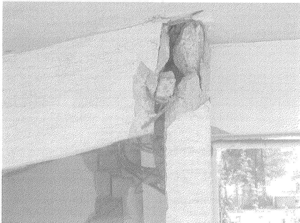
Foto 22. Fallo frágil y súbito de nudo por falta de dimensiones adecuadas.
