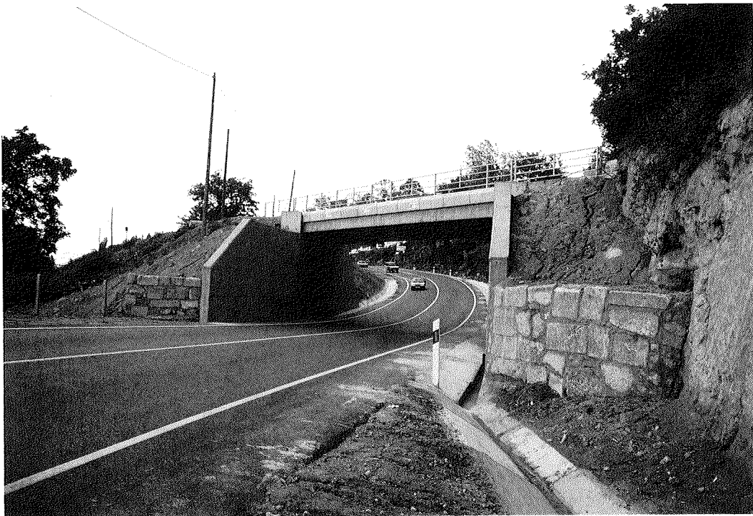
Fig. 19. Puente de F.C. sobre la C.N. 630, en Béjar. Los tabiques, que en su momento sirvieron para apoyo provisional del tablero en construcción, ejercen actualmente la doble función de contención de tierras y de fijación transversal del estribo definitivo.
