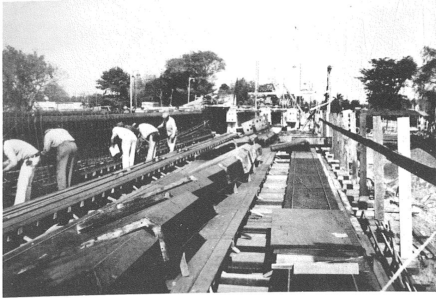
Fig. 8. Preparación de la armadura de las vigas. Se ven también los moldes metálicos utilizados.
