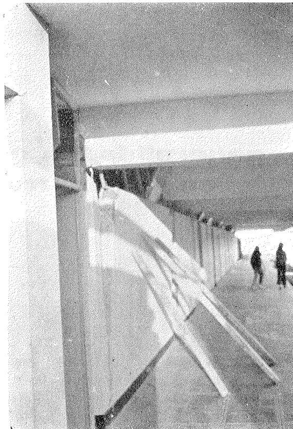
Foto 2. — Vaceamiento de tabique no estructural, por falta de una viga sclera de amarre en el borde superior que lo sujete a la estructura. Chimbote (Perú), sismo 1970.
