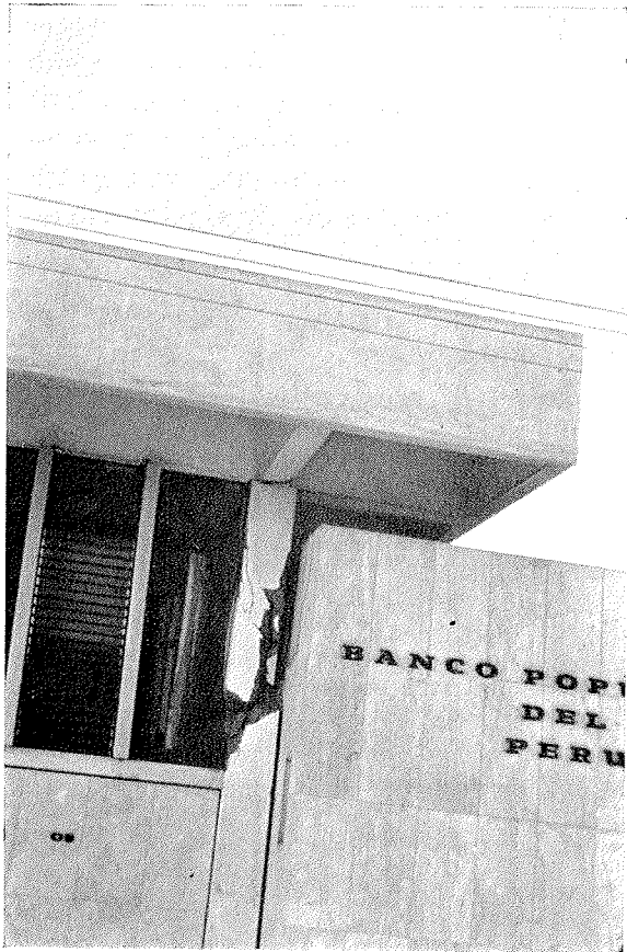
Foto 8.— Interferencia en la vibración de construcciones vecinas o partes de un mismo edificio.
