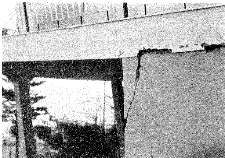
Foto 13. — Muro rígido dañado por la fuerte torsión en planta que sufrió esta vivienda, debido a una distribución asimétrica de rigideces (columnas muy flexibles que giraban alrededor de un núcleo rígido). Papudo (Chile), sismo 1971.
