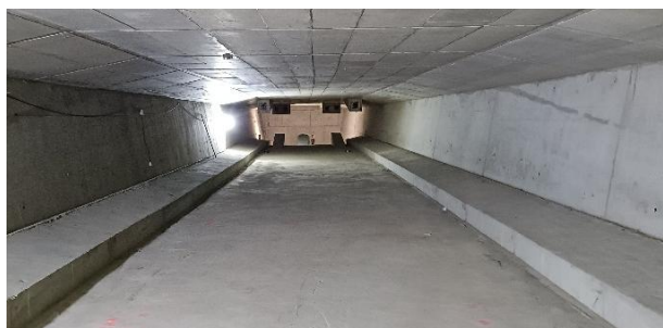
Figura 23. Vista interior del tablero mostrando el recrecido de las cartelas inferiores.
