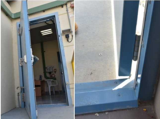
Figura 7. Ejemplos de puerta antiexplosión en una subestación eléctrica. La puerta se modeliza como una placa apoyada en sus cuatro lados sometida a la presión de la onda explosiva aplicada perpendicular a su plano.
