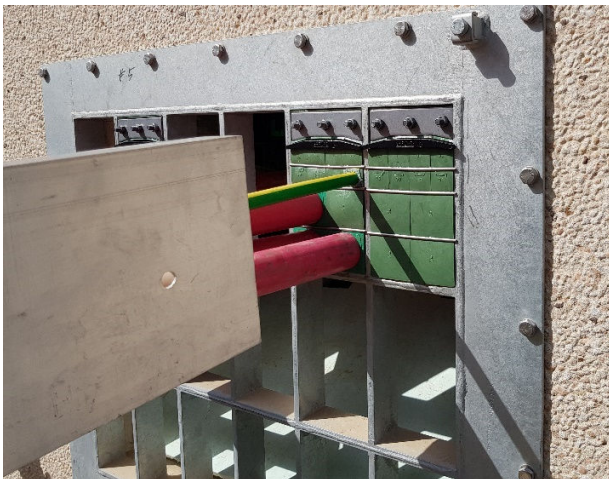
Figura 8. Sistema del tipo MCT para entrada aérea de cableado eléctrico en una subestación.
