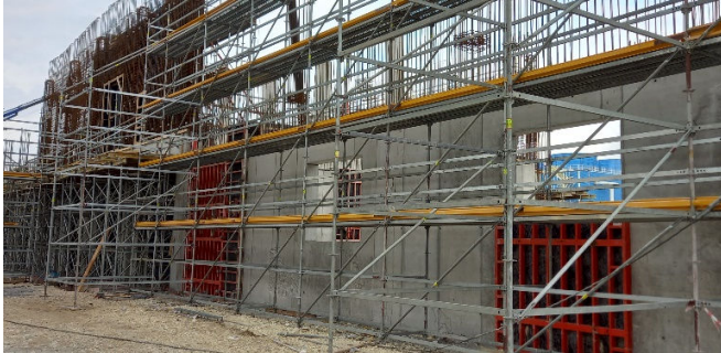
Figura 10. Subestación eléctrica “in situ” durante la fase de ejecución. Se aprecian los medios auxiliares y los distintos niveles de hormigonado para la construcción de huecos.
