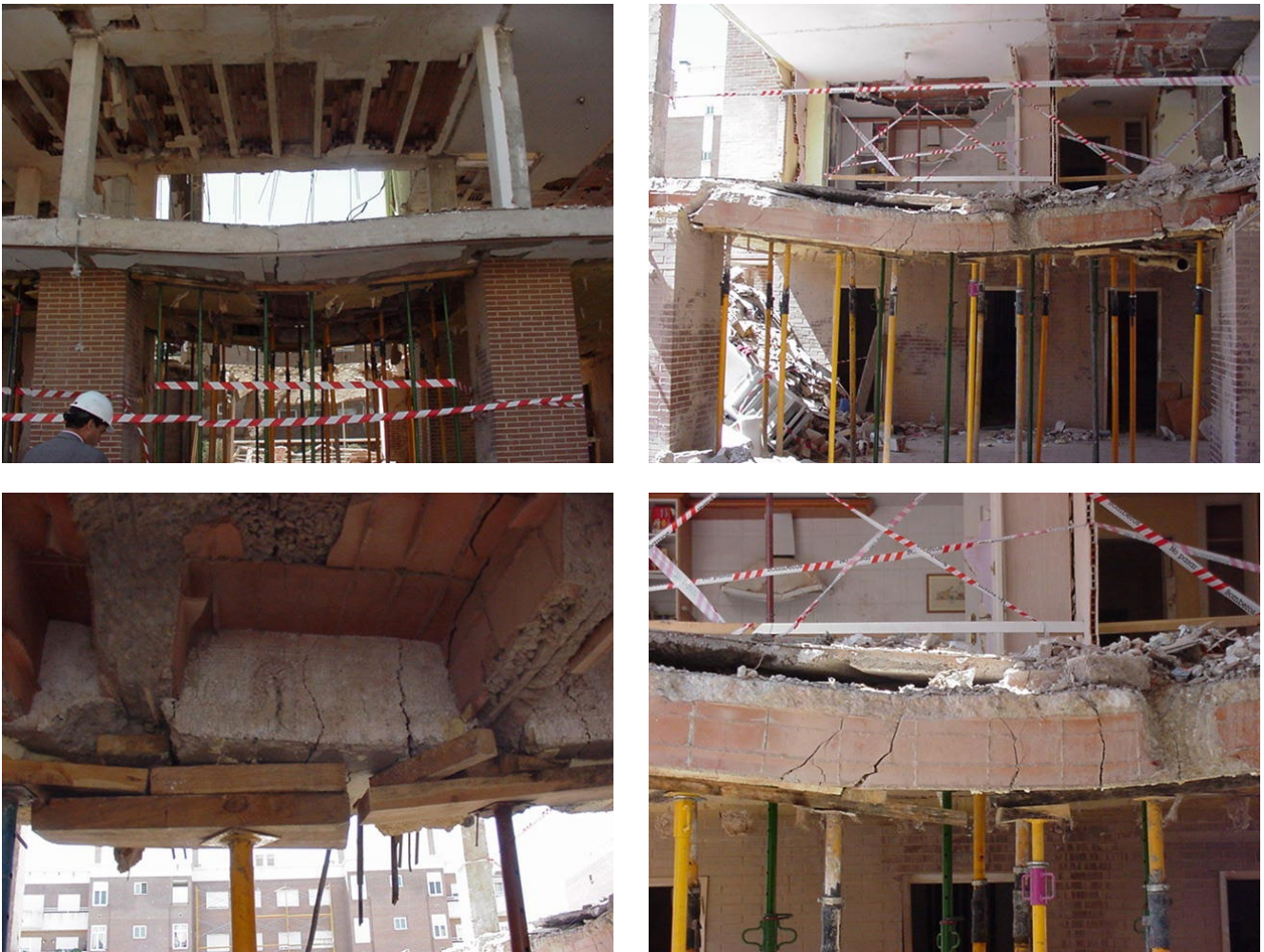
Figura 17: Deformaciones remanentes por flexión en la estructura horizontal y fisuración asociada (Edif. C/ Martín Gaité, Leganés (Madrid). 2004
