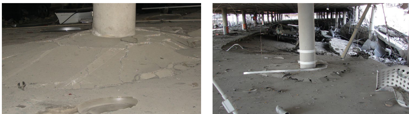
Figura 5: Daños por punzonamiento (Aparcamiento en Aeropuerto de Barajas, Madrid, 2006)
