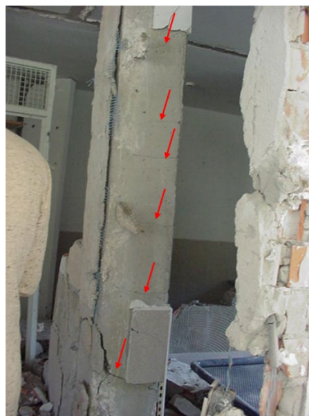
Fisuración horizontal de un soporte que se situaba próximo al foco de la explosión. El edificio sólo tenía planta baja más primera
