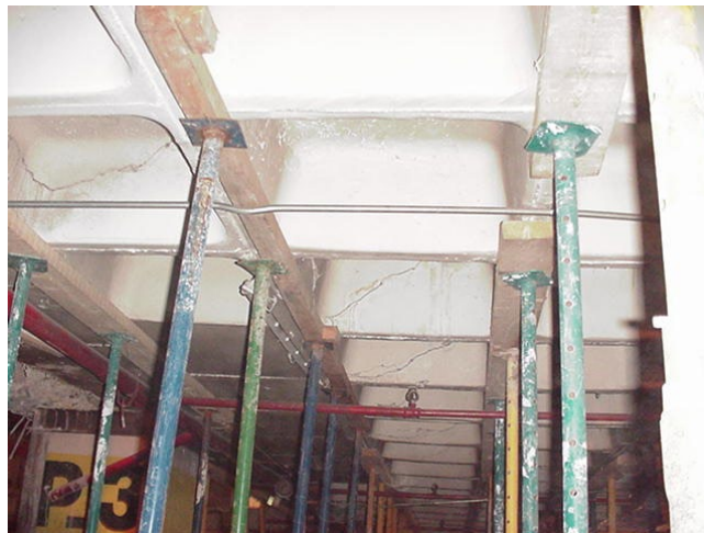
Figura 26: Centro Comercial en Zaragoza (2002). Recuadro de forjado adyacente a muro de sótano afectado, aun estando alejado del foco.
