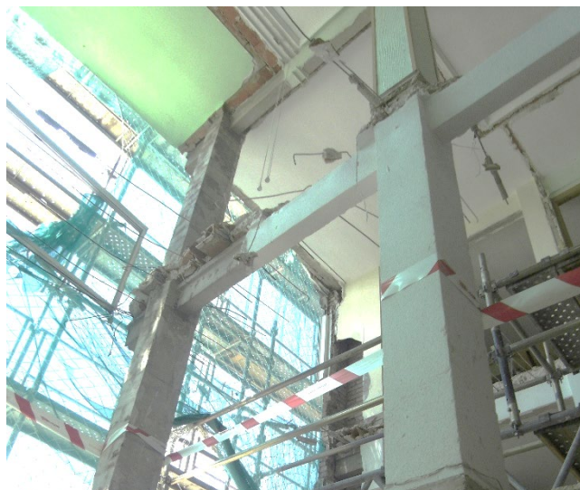
Figura 18: Fallos en forjados en un edificio tras una explosión de gas (Alcalá de Henares, Madrid, 2010).
