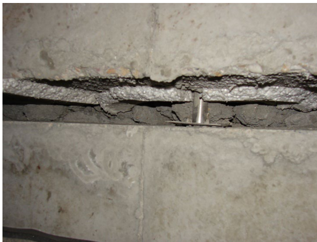
Figura 16: Abertura apreciable en una junta de forjado con pasadores tras los desplazamientos ocurridos como consecuencia de la explosión (Aparcamiento de Barajas, Madrid, 2006).
