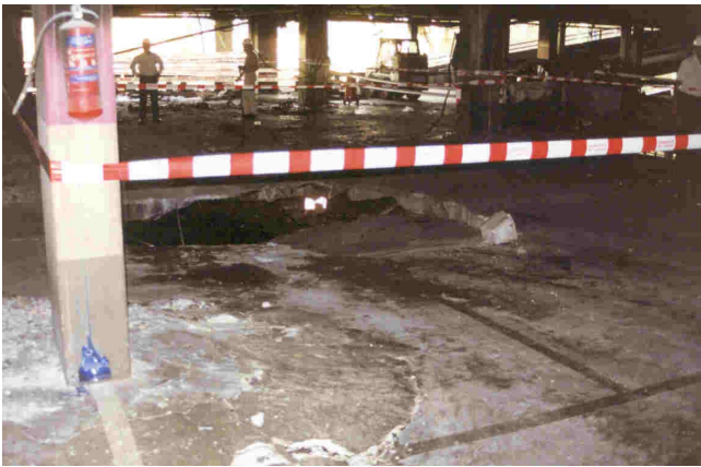
Cara superior. fisuración por punzonamiento
