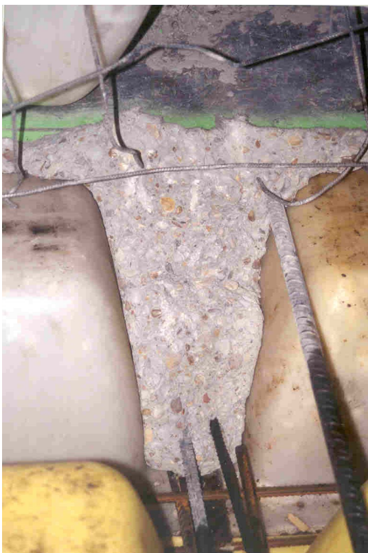
Nervio de forjado. Véase la superficie inclinada, con textura rugosa de árido visto no desprendido
