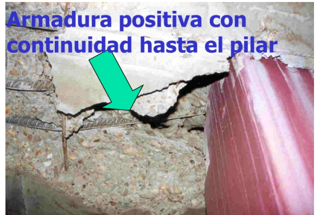
Cara inferior. descenso del forjado al “clavarse” en el pilar y permanencia del mismo colgado de éste a través de la armadura inferior
