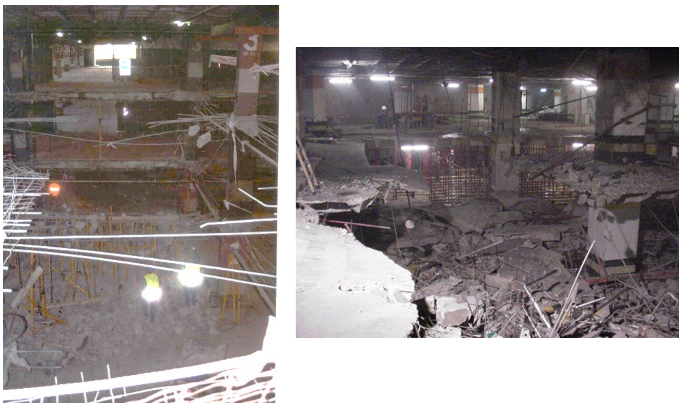
Figura 6: Ejemplo de fallo progresivo hacia plantas inferiores por punzonamiento (fotografía izquierda) y cortante (fotografía derecha) a la salida de ábacos (Aparcamiento P2 del Aeropuerto de Barajas 2001, y Centro Comercial en Zaragoza 2002).
