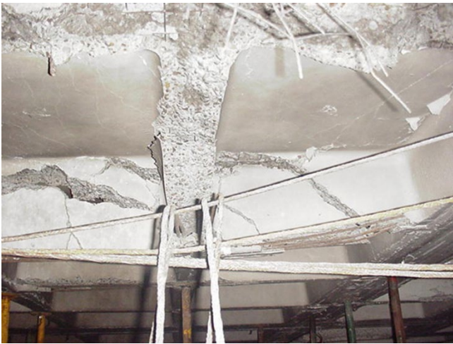
Figura 2: Daños por cortante en nervios de un forjado reticular (Aparcamiento Pza. Colón, Madrid, 2001)
