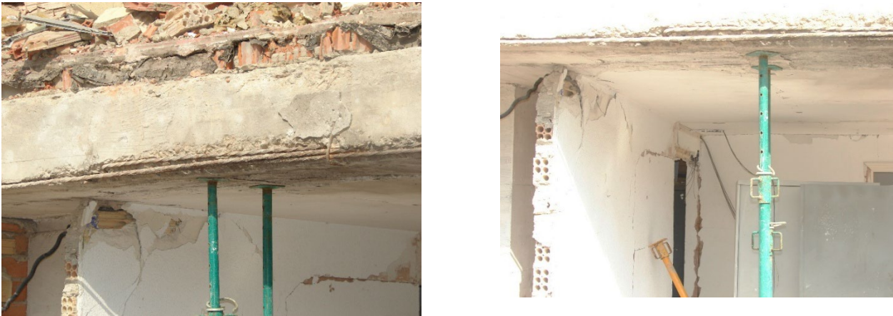
Desconchones en el hormigón
