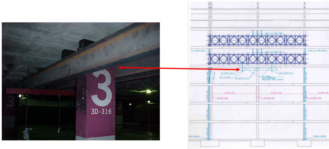
Figura 30: Aparcamiento P2. Apeo de los forjados de los pisos superiores en los que no se realizaban demoliciones.
