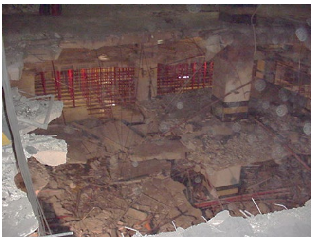
Figura 24: Fallo frágil del forjado en techo sobre el foco de la explosión (Centro Comercial en Zaragoza, 2002).
