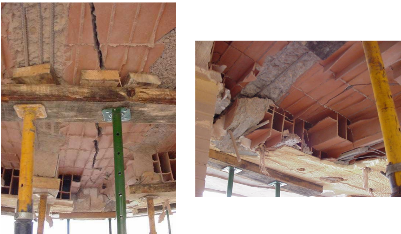
Figura 21: Rotura de la “capa de compresión” en las inmediaciones del foco de la explosión (Edif. C/ Martín Gaité, Leganés, Madrid, 2004).
