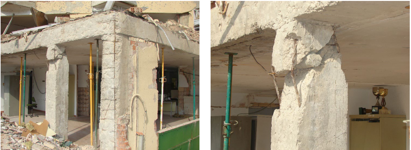
Daños en cabeza de un soporte por una explosión exterior junto a un cuerpo de una única altura adyacente al edificio principal
