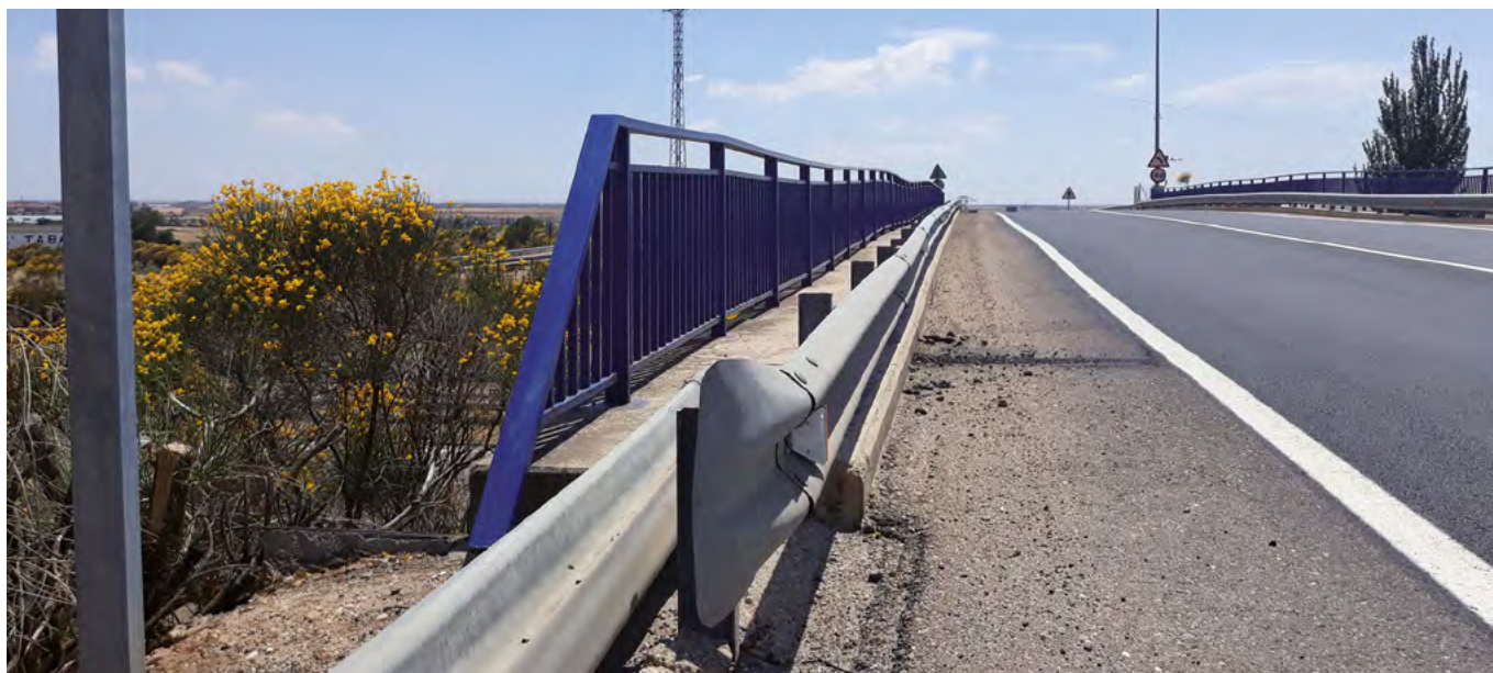
Figura 8. Detalle de la deformación longitudinal de la losa de un tablero.
