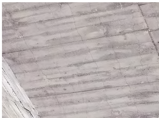
Figura 4. Detalle de fisuras longitudinales abiertas en la cara inferior de la losa de un tablero.
