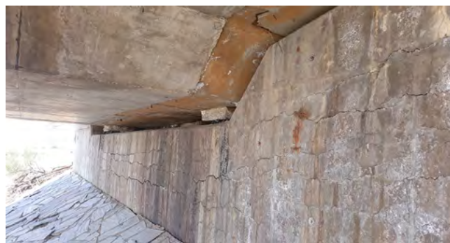
Figura 6. Fisuración horizontal en estribo.
