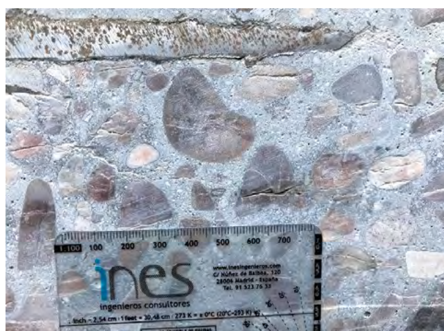
Figura 10. Fisuras con rotura de áridos, a veces rellenas de material de la reacción, observadas en un corte transversal de una estructura afectada por AAR.
