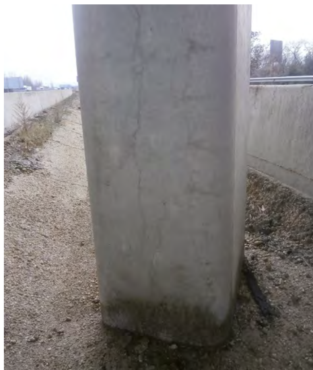
Figura 7. Fisuración vertical en una pila.
