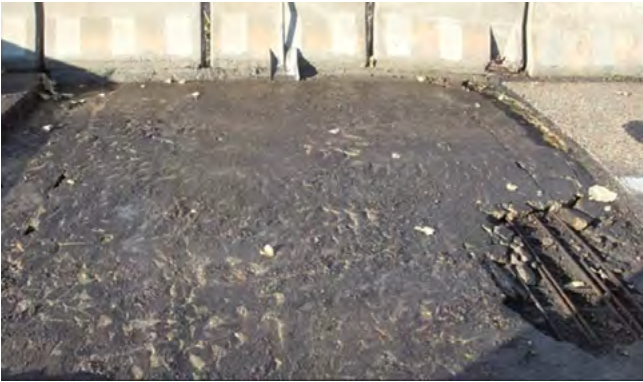
Figura 4. Demolición del pavimento en la zona afectada. Pueden observarse roturas de la losa de compresión.
