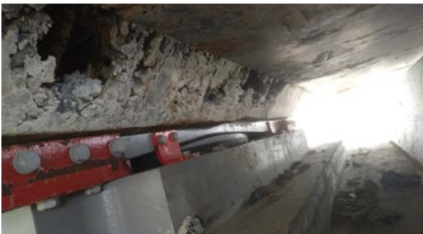
Figura 24. Apoyo tipo pot de pila 5 sobre plinto defectuoso
