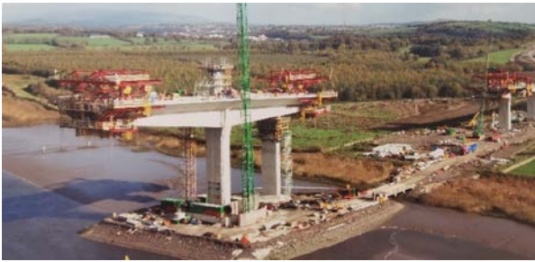
Figura 14. Voladizo en pila 4 (y Push-pull prop)
