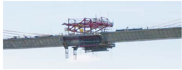
Figura 21. Flecha diferencial en voladizo de vano 4
