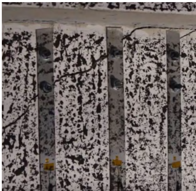
Figura 8. Detalle de fisura que se propaga produciendo el fallo de los anclajes mecánicos en el alma.
