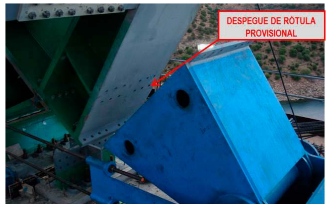
Figura 29. Separación rótula provisional.
