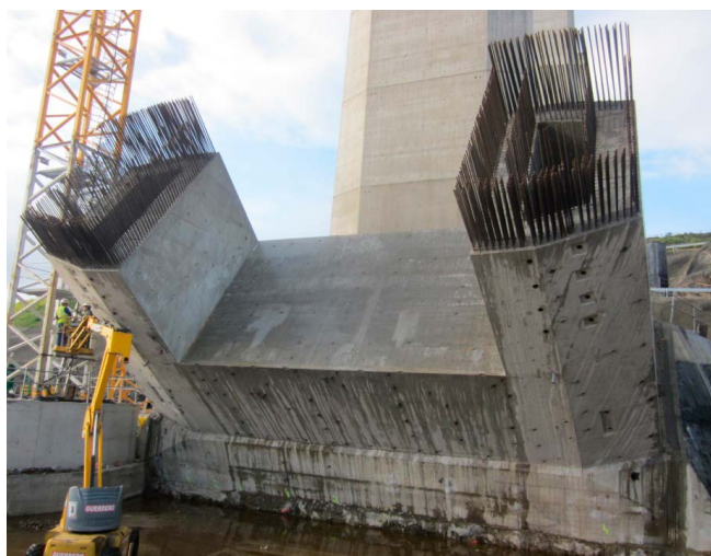
Figura 7. Dovelas 1 y 2 del arco.
