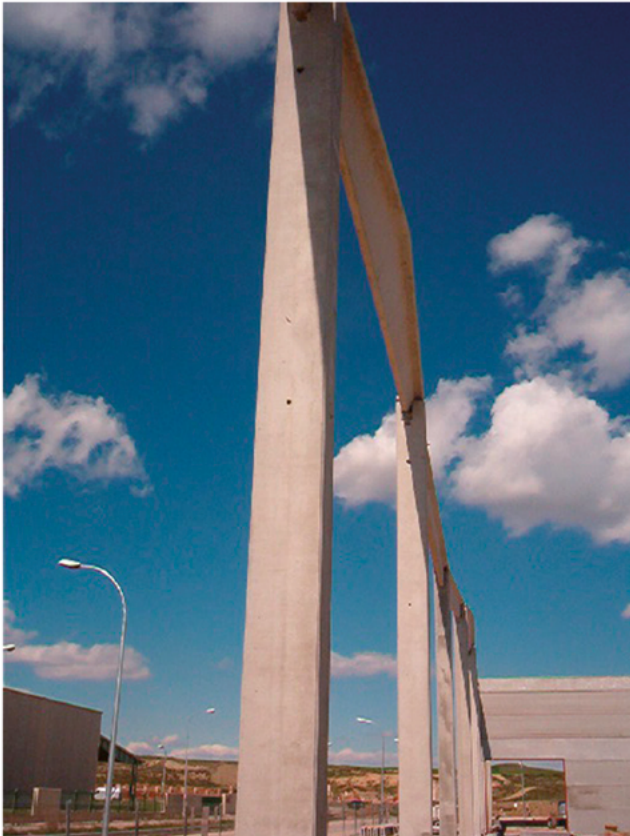
Figura 11. Vuelco en «vigas delta».
