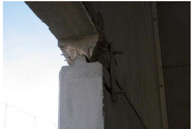
Figura 28. Descantillado en paneles de fachada por tensiones localizadas.
