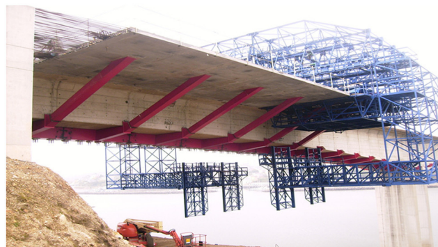
Figura 33. Cimbra móvil para la instalación de jabalcones y hormigonado de la losa ampliada.
