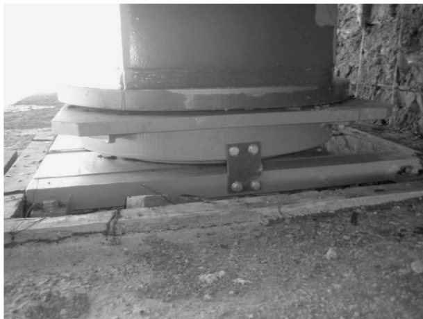
Figura 42. Aparatos de apoyo tipo POT. Puede observarse que, contrariamente a lo habitual, la placa de deslizamiento se dispuso debajo del apoyo para facilitar el centrado del apoyo en la pata metálica.
