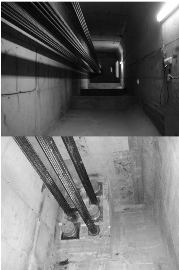
Figura 35. Arriba: fotografía del pretensado exterior en el interior del cajón con vista de uno de los desviadores. Abajo: vista de los anclajes activos y pasivos del pretensado exterior situado en el interior del cajón, en las riostras de pila.
