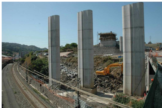
Figura 29. Pilas de la zona de transición.
