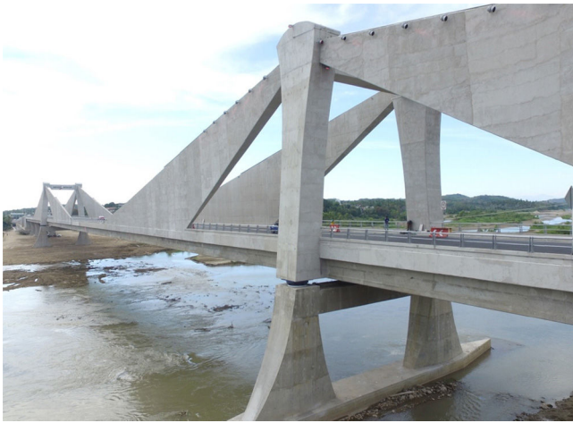
Figura 7. Torres de atirantamiento.
