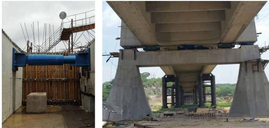
Figura 4. Aisladores sísmicos longitudinales en estribo I y transversales bajo una de las torres. Bajo el tablero se ven los apoyos definitivos, los balancines para el empuje y el amortiguador transversal.
