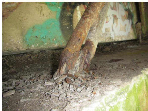
Figura 8. Estado barras antisísmicas
