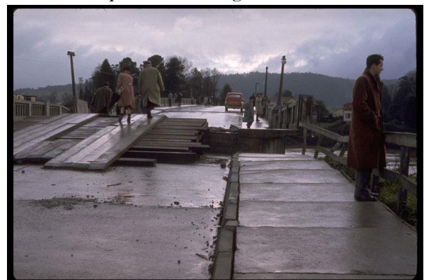
Figura 2. Puente tras el Sismo de 1960
