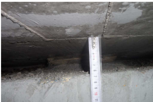
Figura 5. Detalle del reducido espacio disponible entre el estribo y el tablero en la zona de apoyos.
