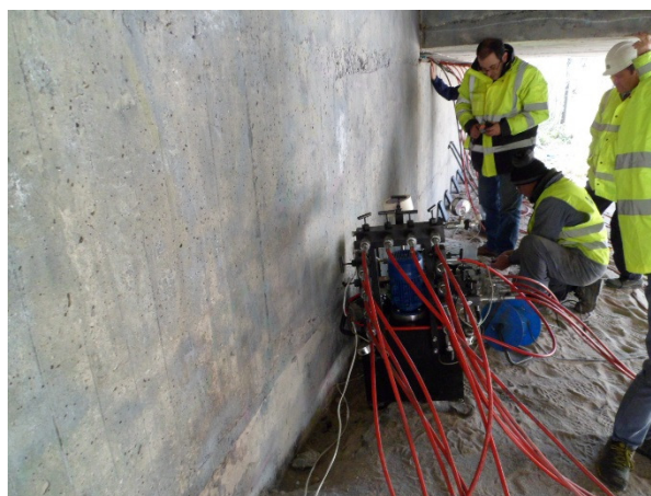
Figura 9. Centralita hidráulica para control de la presión en los gatos de forma simultánea.
