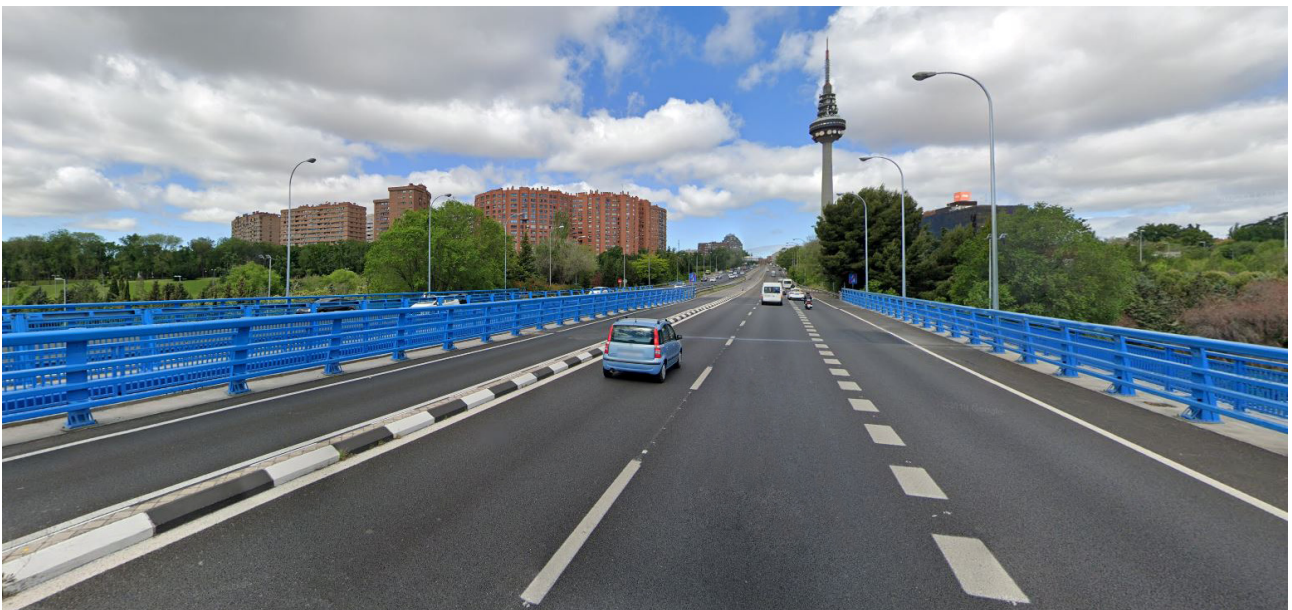
Figura 21. Vista de la calzada Norte tras las actuaciones de rehabilitación y adecuación.
