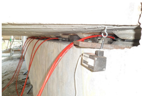
Figura 8. Sensor de desplazamiento instalado para control de la maniobra.
